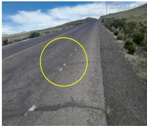
Fotografía 21: Demarcaciones laterales del TCA N° 01 en estado de deterioro.
