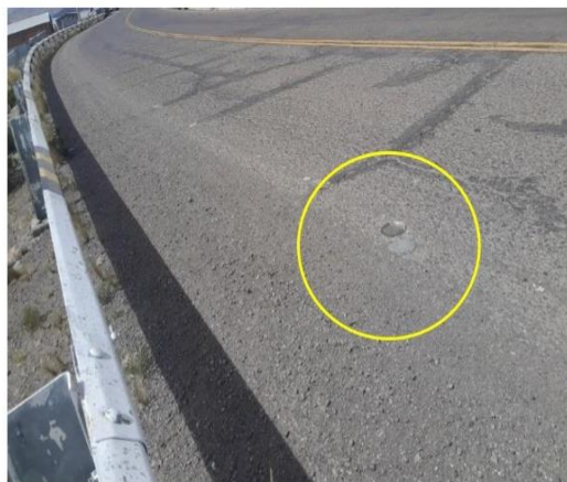
Fotografía 23: Desprendimiento de tachas reflectivas en el TCA N° 09.
