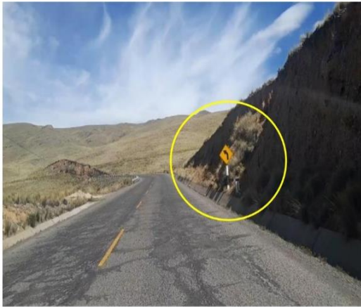
Fotografía 19: La señalización vertical tipo P-2B presenta daños a consecuencia del derrumbe
