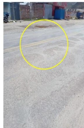
Fotografía 22: Demarcaciones del TCA N° 09 en estado deteriorado afectando
