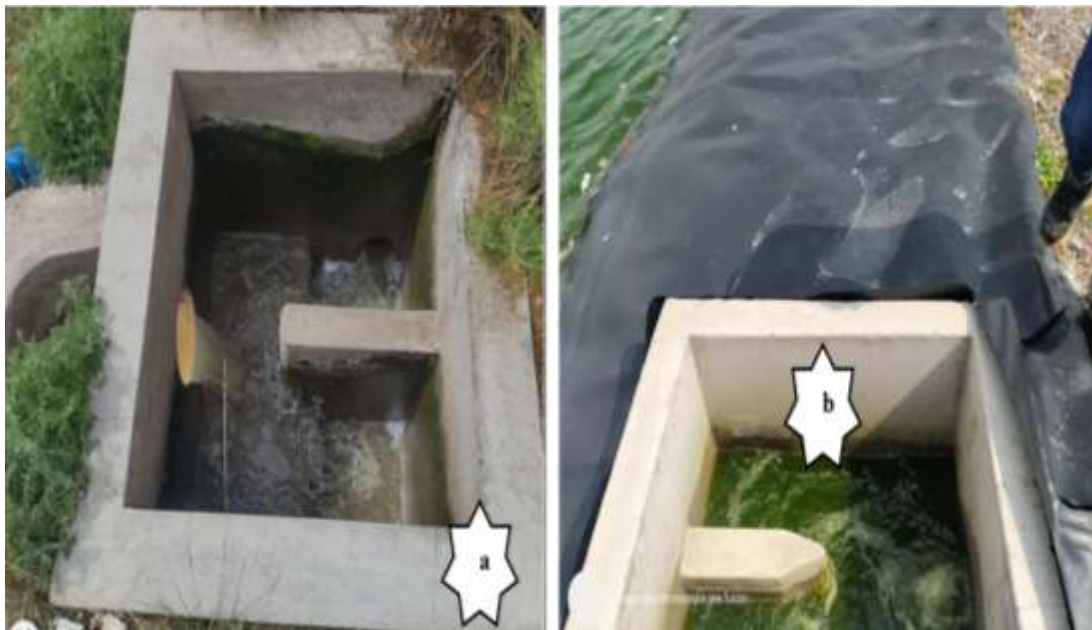
Fotografía 2. Cámaras repartidoras de aguas residuales en la PTAR Santa Lucía.
