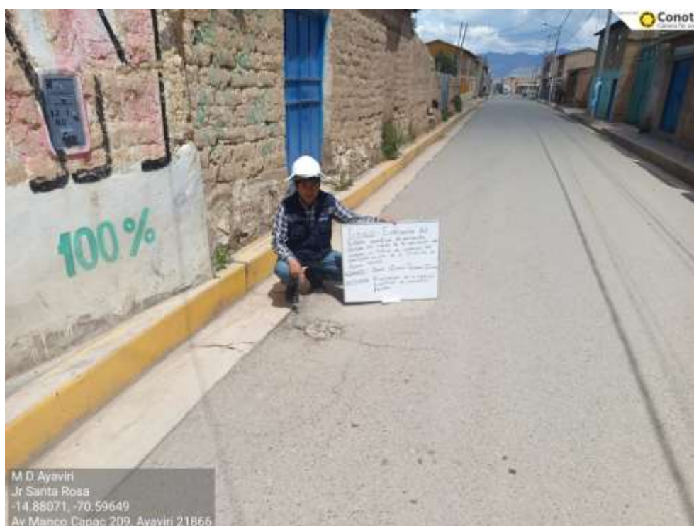
Fotografía 1. Parcheo en severidad media en Jr. Santa Rosa
