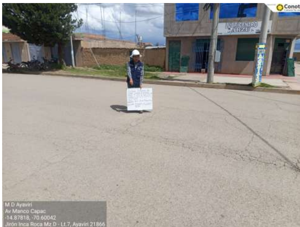
Fotografía 20. Piel de cocodrilo en severidad alta en Av. Manco Capac
