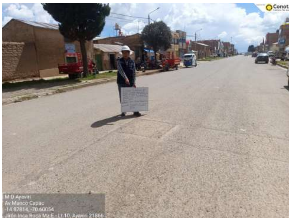
Fotografía 23. Parcheo en severidad media en Av. Manco Capac
