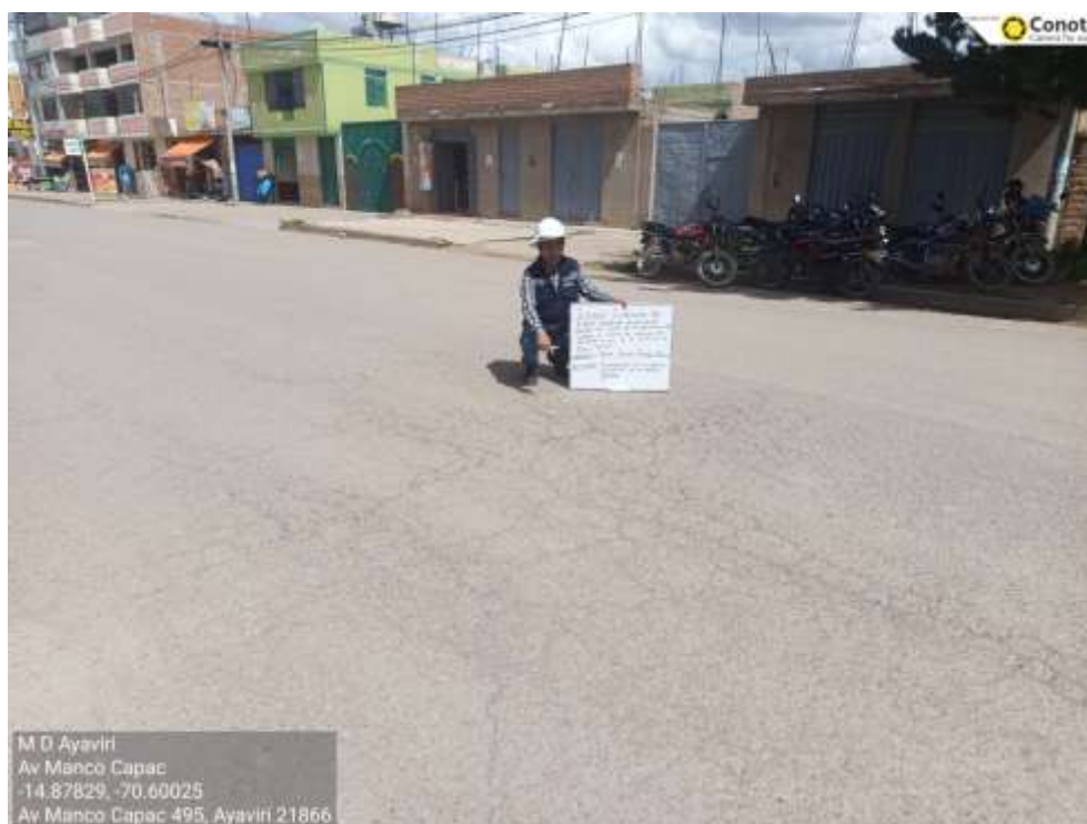
Fotografía 19. Piel de cocodrilo en severidad media en Av. Manco Capac
