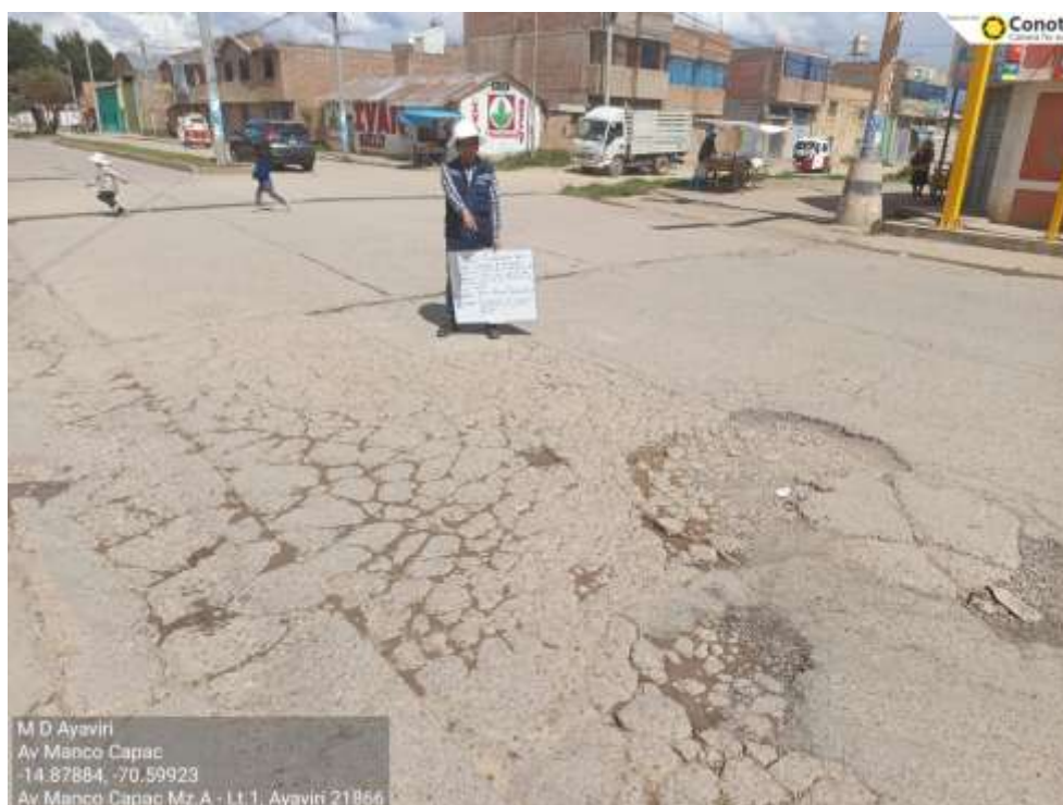
Fotografía 13. Piel de cocodrilo y hueco en severidad alta en Av. Manco Capac
