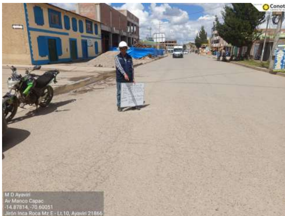
Fotografía 22. Grieta parabólica en severidad baja en Av. Manco Capac
