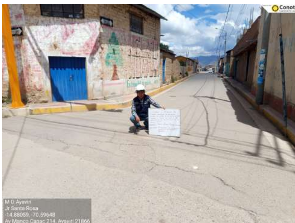
Fotografía 6. Agrietamiento en bloque en severidad media en Jr. Santa Rosa
