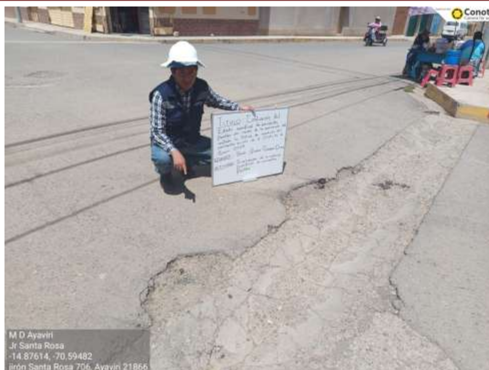
Fotografía 11. Grieta de borde en severidad alta en Jr. Santa Rosa
