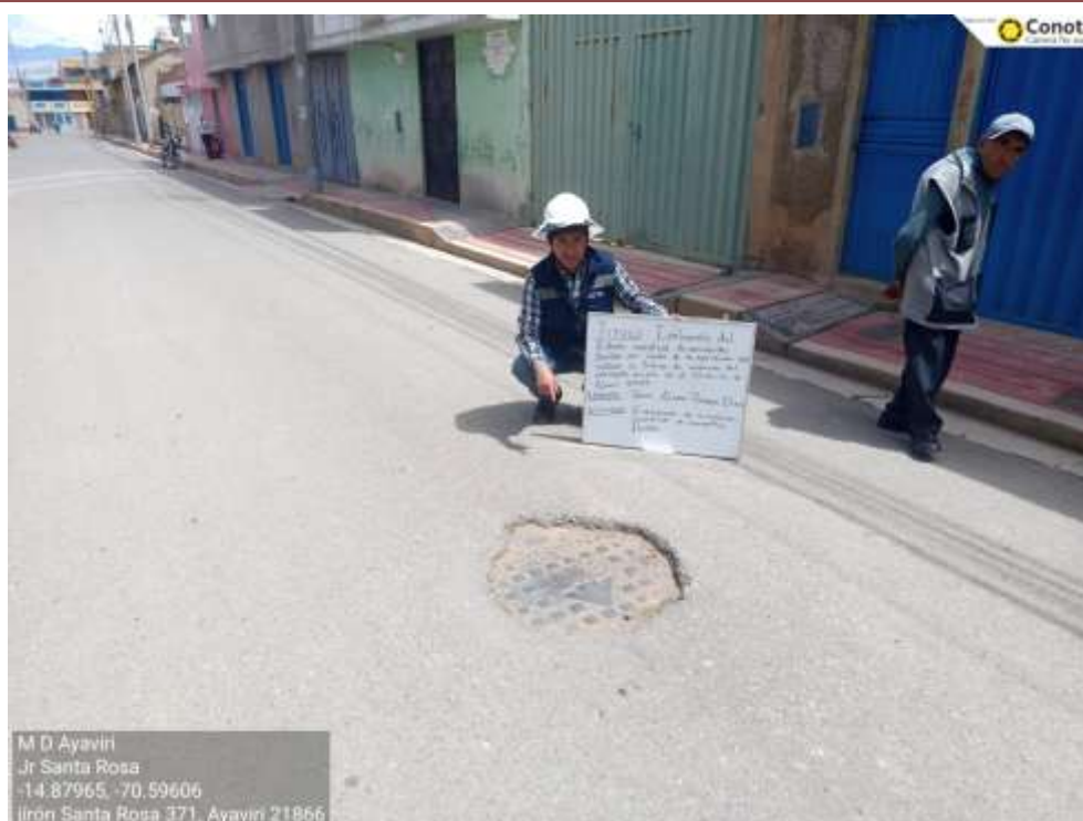
Fotografía 5. Hueco en severidad media en Jr. Santa Rosa
