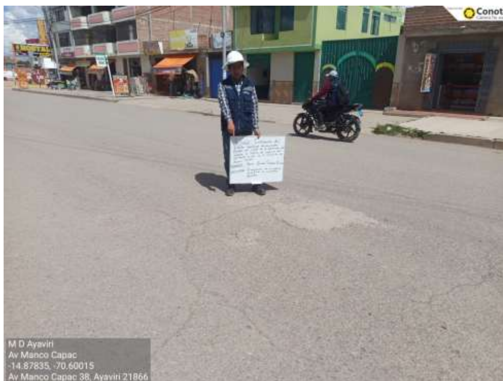
Fotografía 17. Parcheo y fisuras long. / transv. en severidad media en Av. Manco Capac
