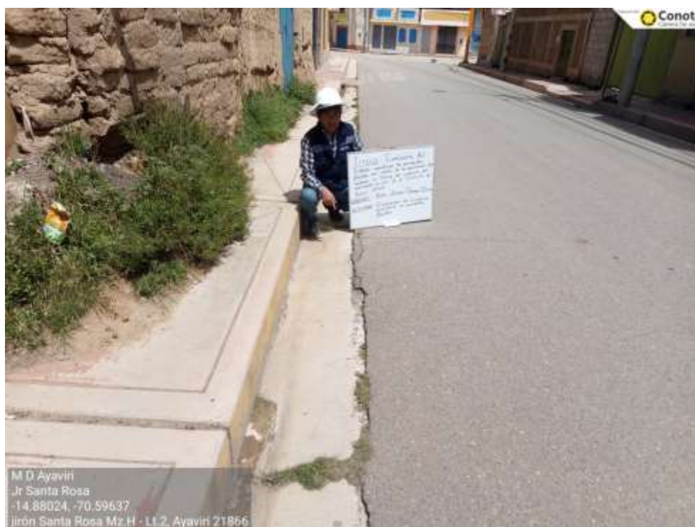
Fotografía 3. Grieta de borde en severidad media en Jr. Santa Rosa
