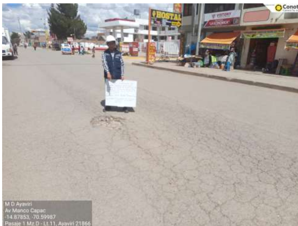
Fotografía 15. Piel de cocodrilo y hueco en severidad media en Av. Manco Capac
