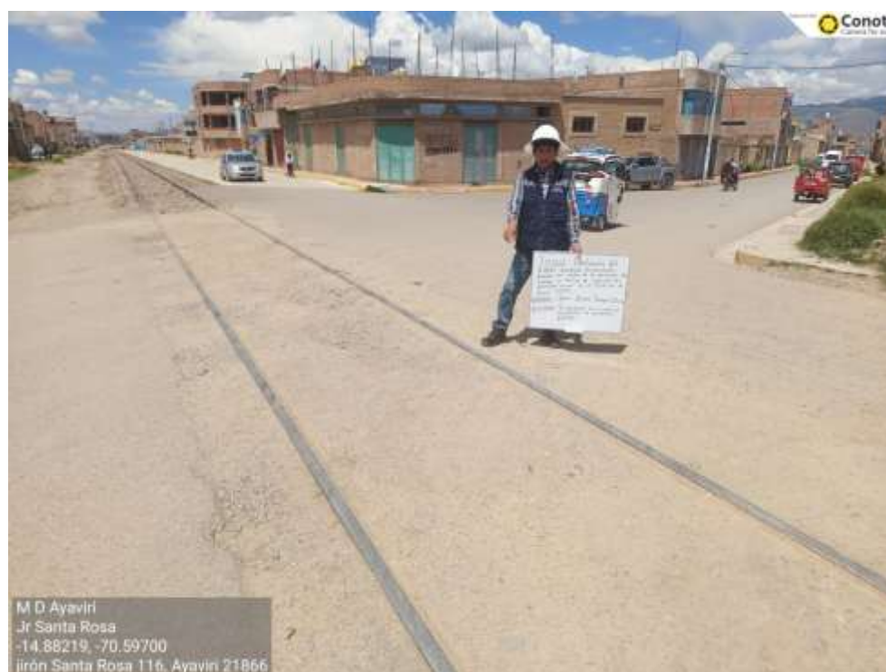
Fotografía 12. Cruce de vía férrea en severidad media en Jr. Santa Rosa
