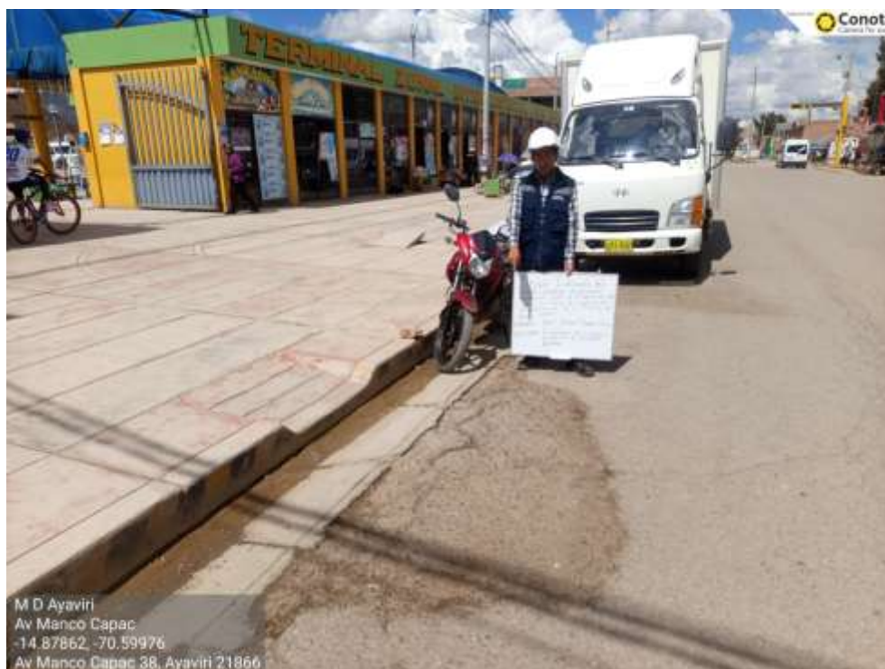
Fotografía 18. Grieta de borde en severidad alta en Av. Manco Capac
