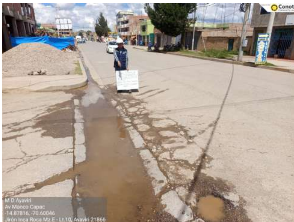
Fotografía 21. Grieta de borde en severidad alta en Av. Manco Capac
