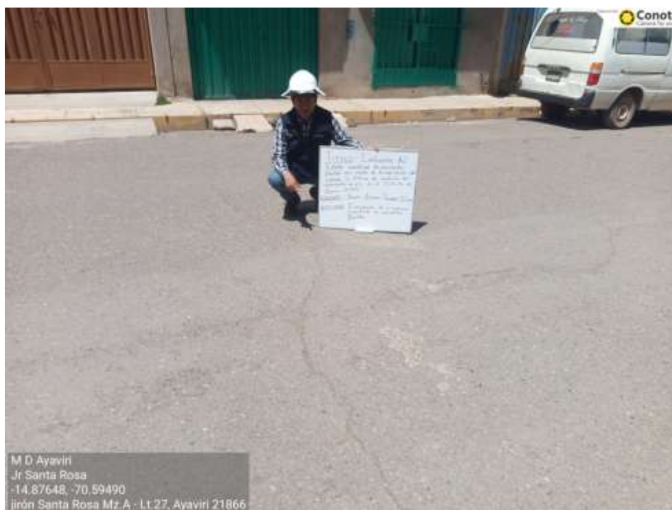
Fotografía 9. Fisuras long. / transv. en severidad media en Jr. Santa Rosa
