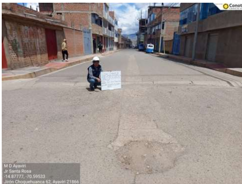
Fotografía 8. Parcheo y hueco en severidad media en Jr. Santa Rosa
