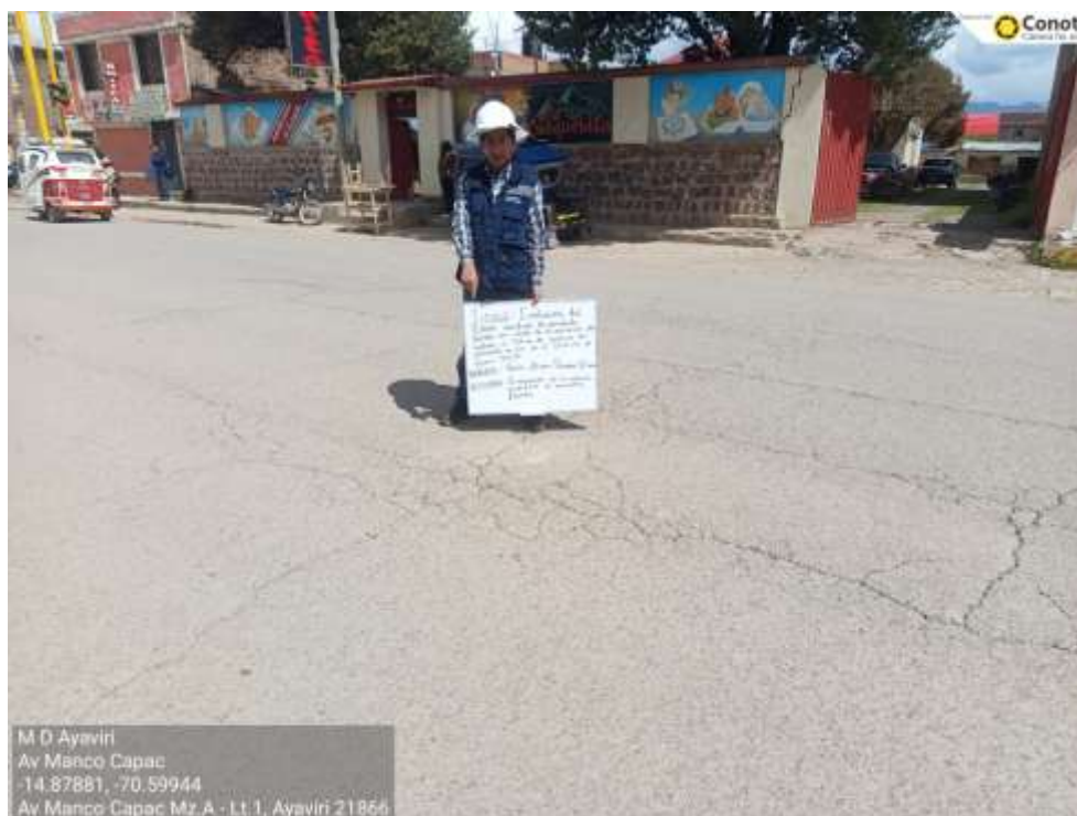
Fotografía 14. Piel de cocodrilo y fisuras long. / transv. en severidad media en Av. Manco Capac
