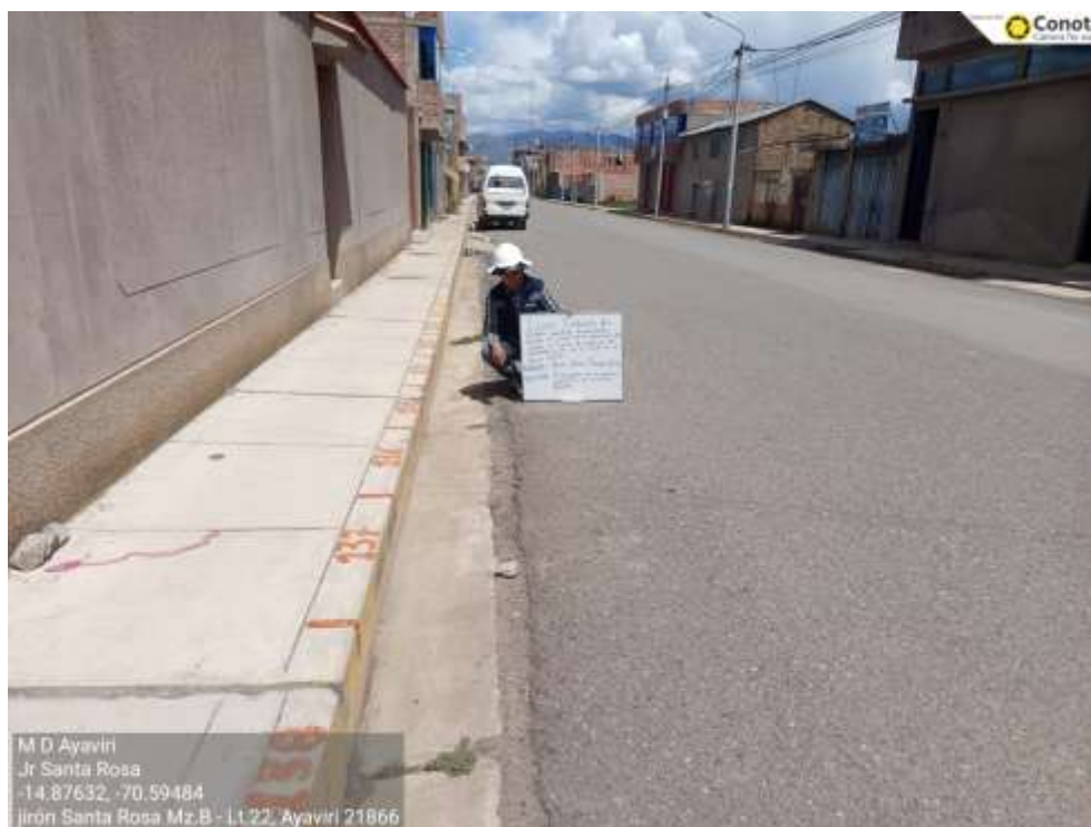
Fotografía 10. Desnivel carril / berma en severidad media en Jr. Santa Rosa
