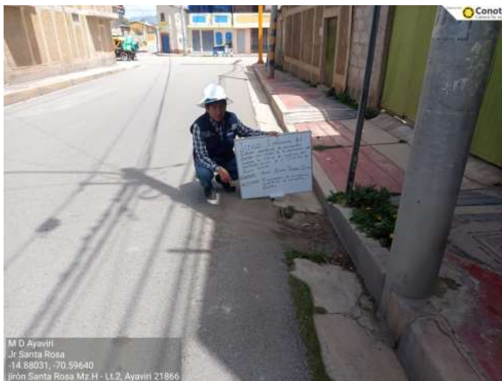
Fotografía 4. Desnivel carril / berma en severidad media en Jr. Santa Rosa
