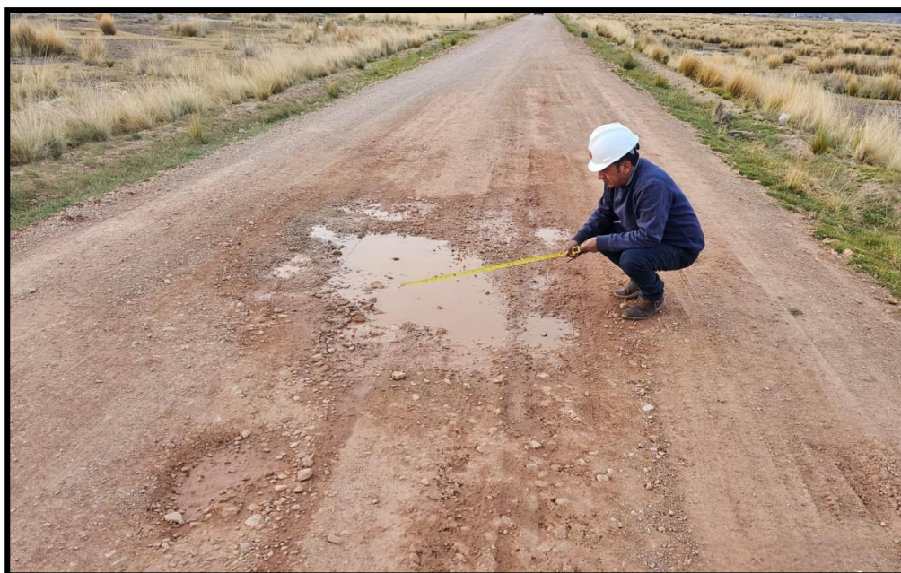
Fotografía 4. Tramo progresiva km 01+900 Calzada en mal estado
