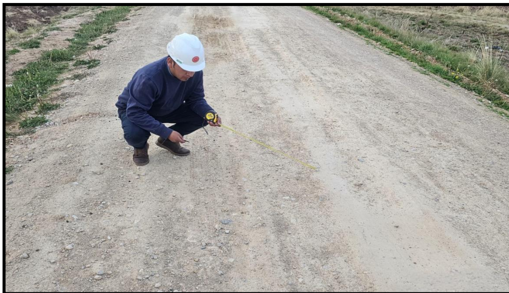
Fotografía 3. Tramo progresiva km 01+500 calzada en mal estado
