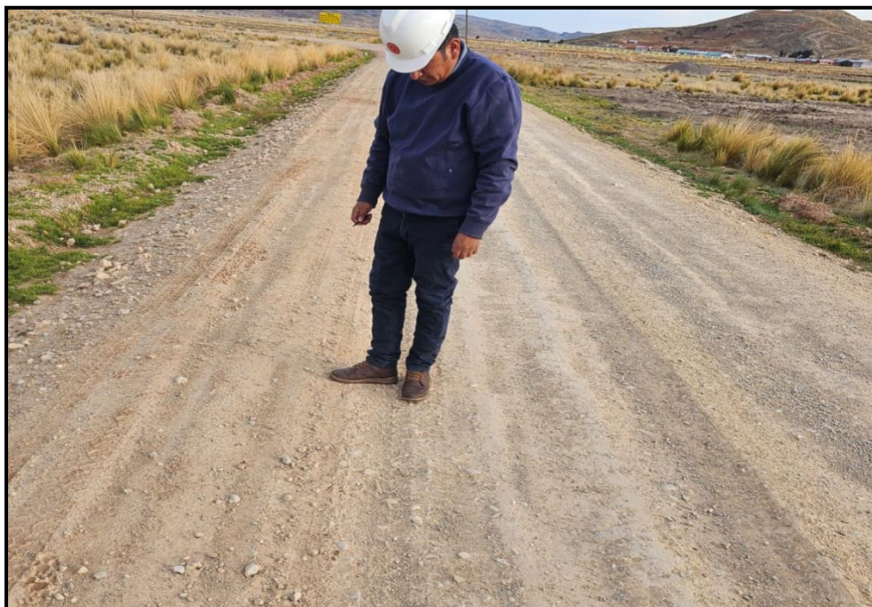
Fotografía 1. Tramo progresiva km 0+400 KM deterioro superficial de calzada
