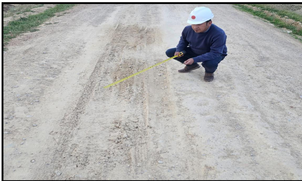
Fotografía 12. Tramo progresiva km 04+250 Baches afectan la transitabilidad
