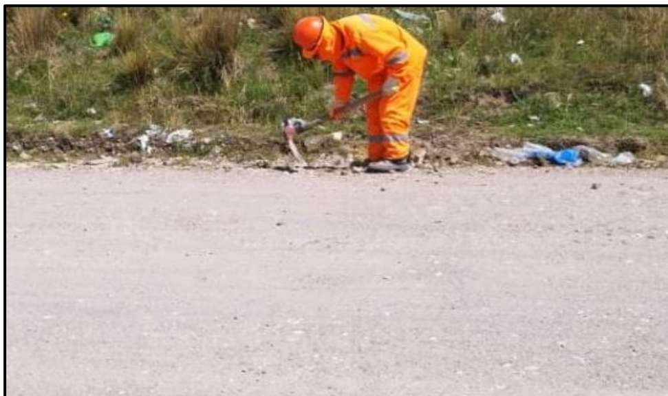
Fotografía 2. Tramo progresiva km 01+100 Cunetas en un estado deficiente
