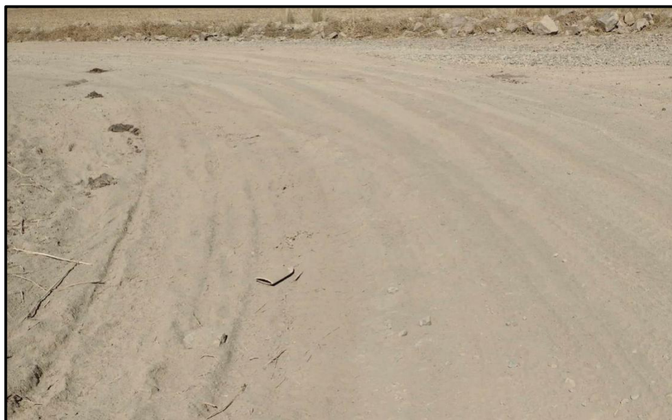
Fotografía 14. Tramo progresiva km 04+600 muestra un deterioro superficial en la vía
