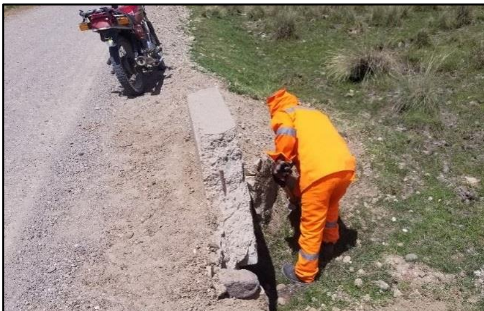
Fotografía 5. Tramo progresiva km 02+400 alcantarilla en mal estado
