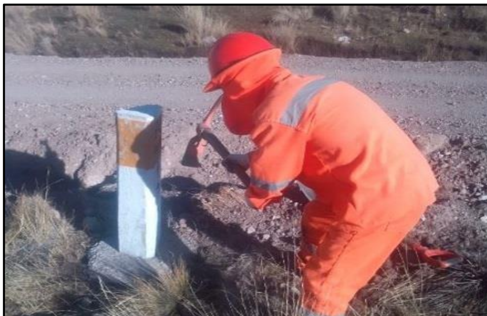
Fotografía 6. Tramo progresiva km 03+000 señalizaciones en un mal estado
