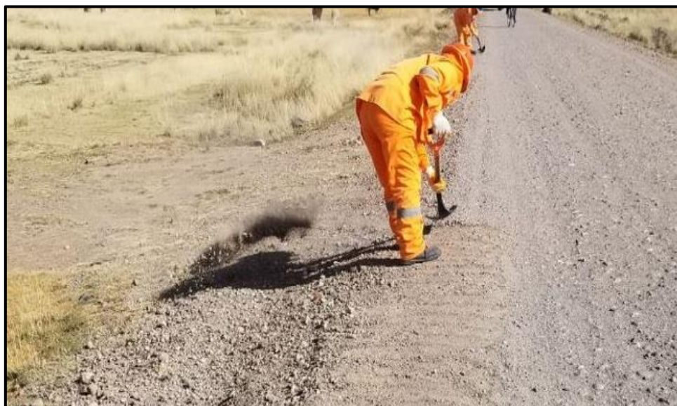
Fotografía 7. Tramo progresiva km 03+400 cunetas en un estado defectuoso
