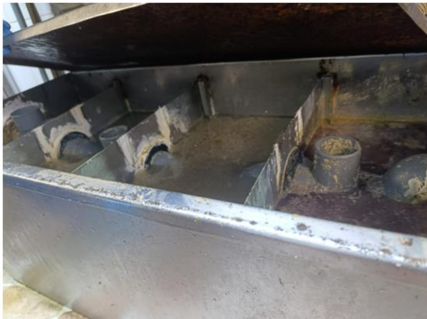
Foto N°10. Estructura del interceptor de grasa.
