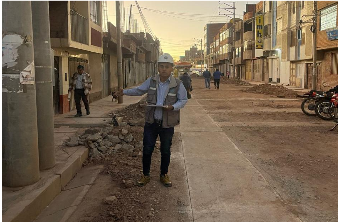
Fotografía 4. Construcción de canal pluvial reparación de pavimentos renovación de señales de tráfico en el jr. Bracesco
