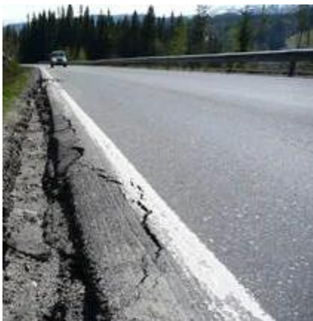
Fisuras de bordes en pavimentos
