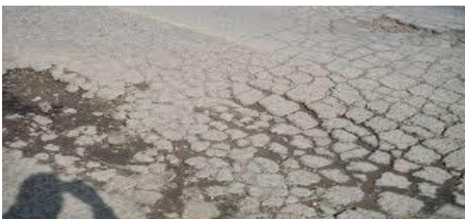
Piel de Cocodrilo en Pavimentos
