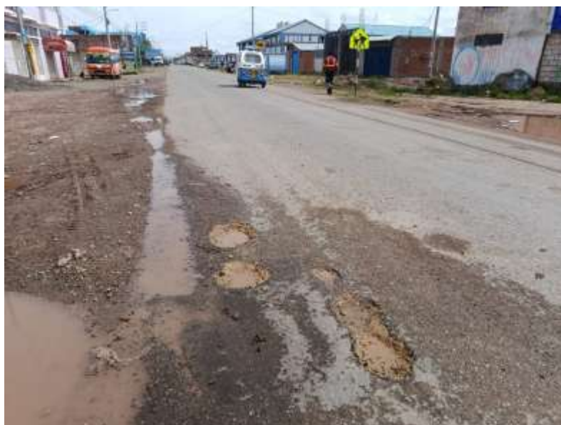
Fotografía 7. Huecos - Salida a Caminaca
