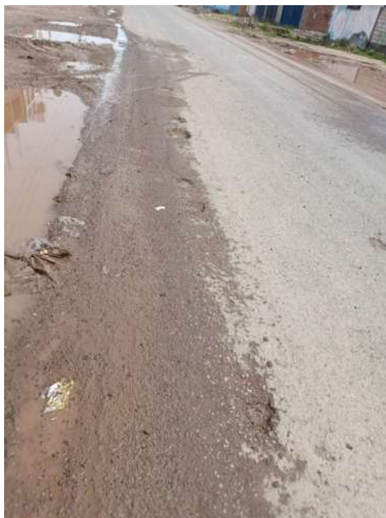
Fotografía 8. Huecos - Salida a Caminaca
