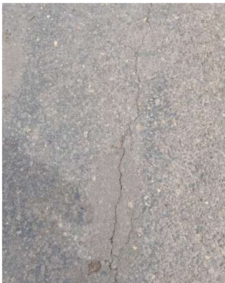
Fotografía 12. Fisuras longitudinales - Salida a Caminaca
