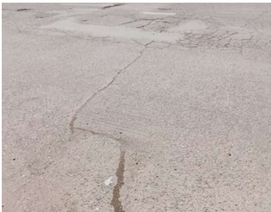
Fotografía 2. Falla de fisuras transversales y piel de cocodrilo – Salida Arequipa
