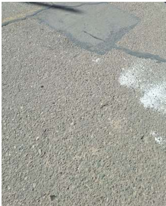
Fotografía 6. Falla de parcheo y pulimiento de agregados - Salida a Caminaca
