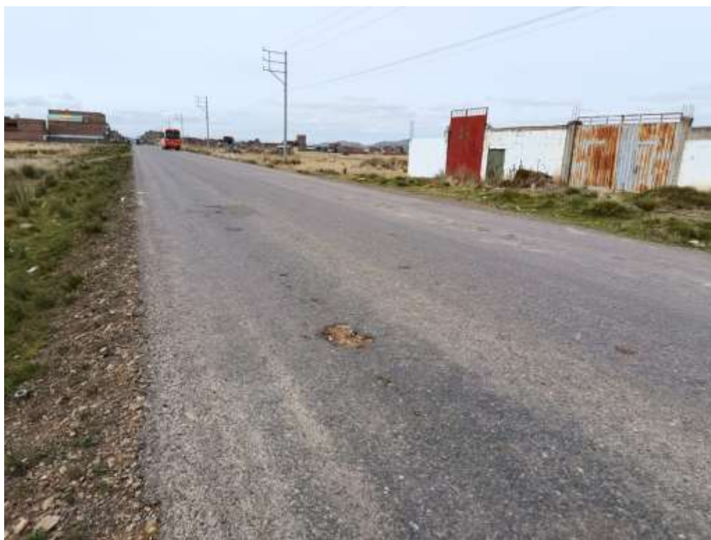
Fotografía 10. Huecos - Salida a Caminaca
