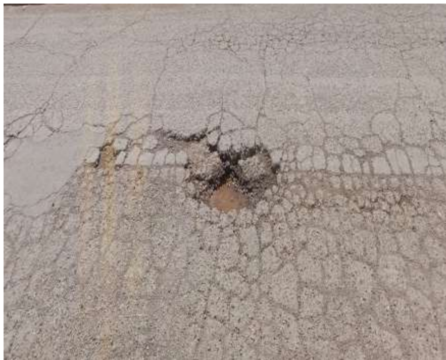
Fotografía 1. Falla de hueco con piel de cocodrilo – Salida Arequipa
