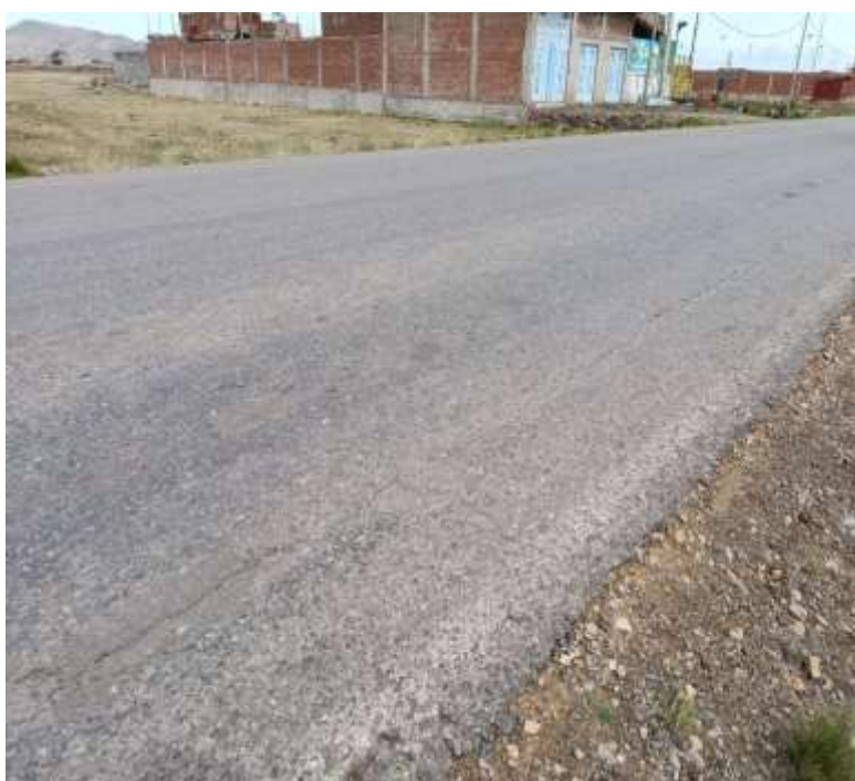
Fotografía 11. Fisuras longitudinales - Salida a Caminaca
