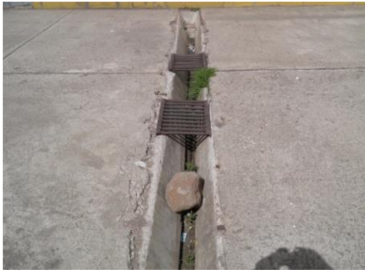
FOTOGRAFÍA 2: canales de agua fluvial oxidados
