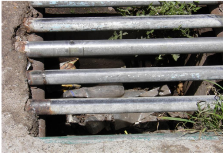
FOTOGRAFÍA 1: canal de aguas fluviales deterioradas
