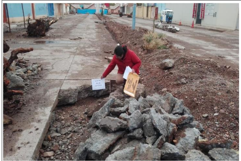
Foto N° 07: Vista 05 de rotura de pavimentos.
