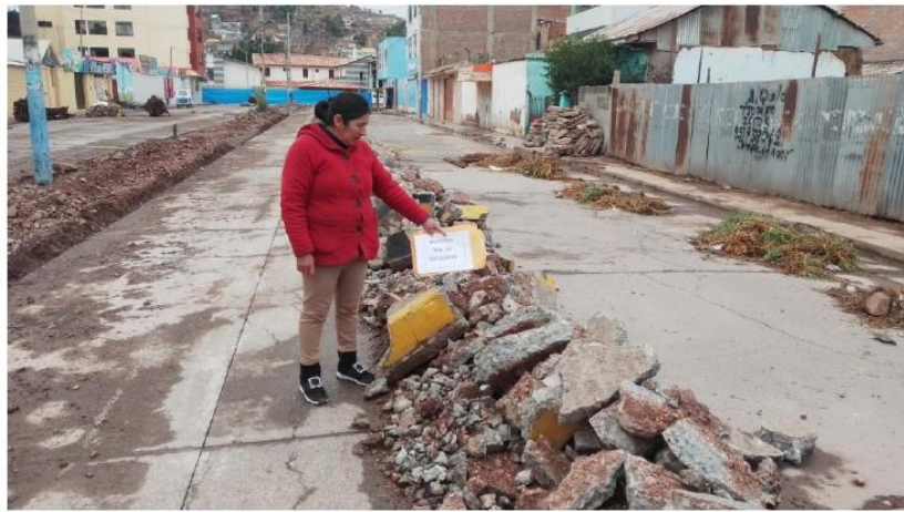
Foto N° 09: Vista 06 de rotura de pavimentos.
