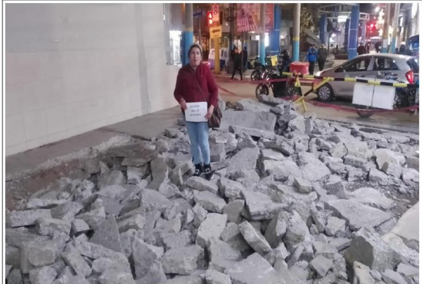
Foto N° 03: Se. Vista 02 de rotura de pavimentos.
