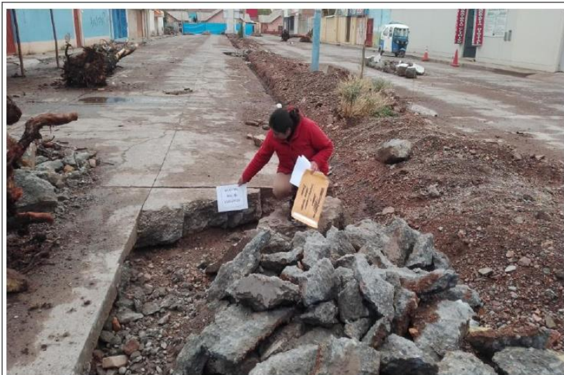
Foto N° 06: Vista 04 de rotura de pavimentos.
