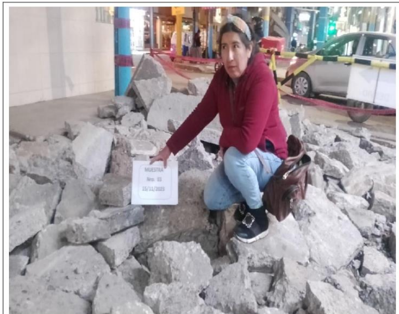
Foto N° 02: Vista 01 de rotura de pavimentos.
