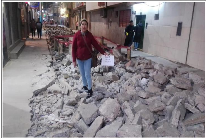
Foto N° 05: Vista 04 de rotura de pavimentos.
