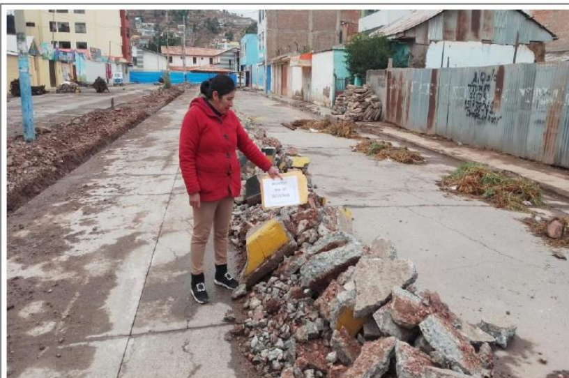
Foto N° 08: Vista 06 de rotura de pavimentos.
