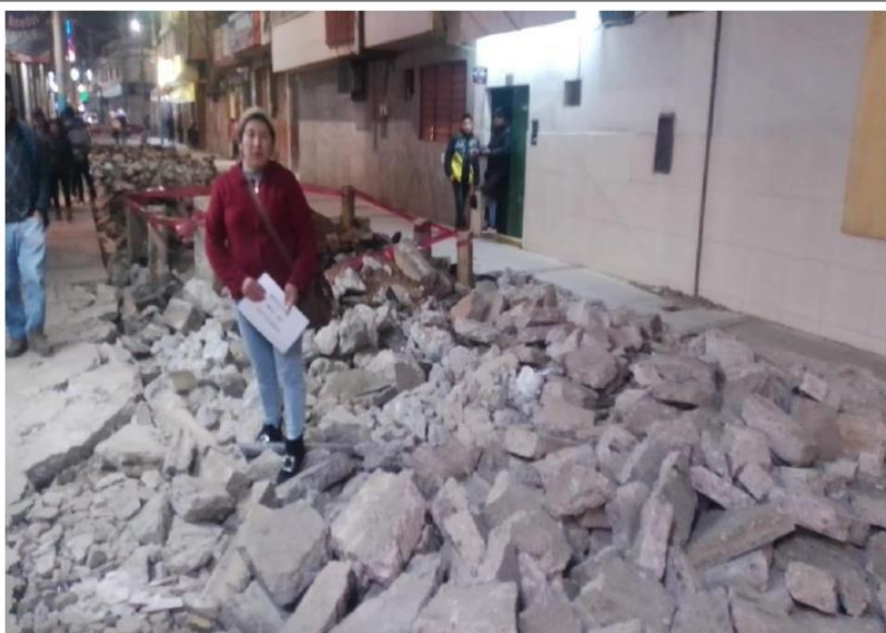
Foto N° 04: Vista 03 de rotura de pavimentos.
