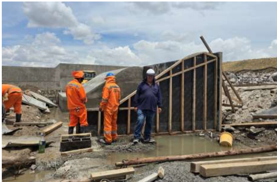
Vaciado del cuerpo del azud empleando concreto f'c = 140 \text{ kg/cm}^2 + 30\% \text{ PG} , de ancho 4.20m distribuido en 6 partes con juntas cada 5.87mts.
