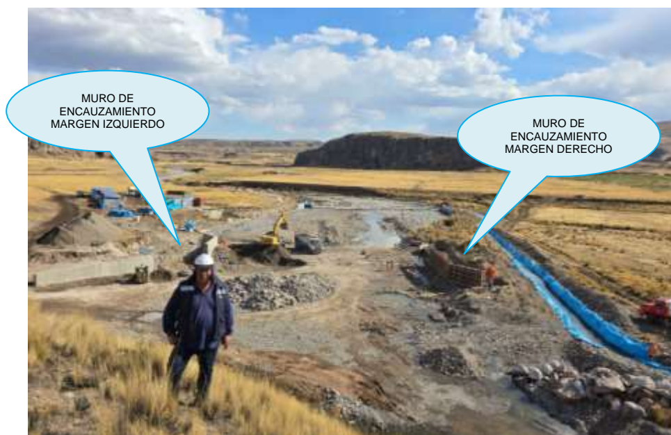
Vista general aguas arriba y aguas abajo del sistema de captación barraje mixto.
