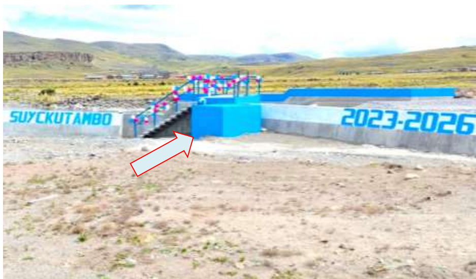
Caja de válvula de control para regular la captación del caudal de diseño.
