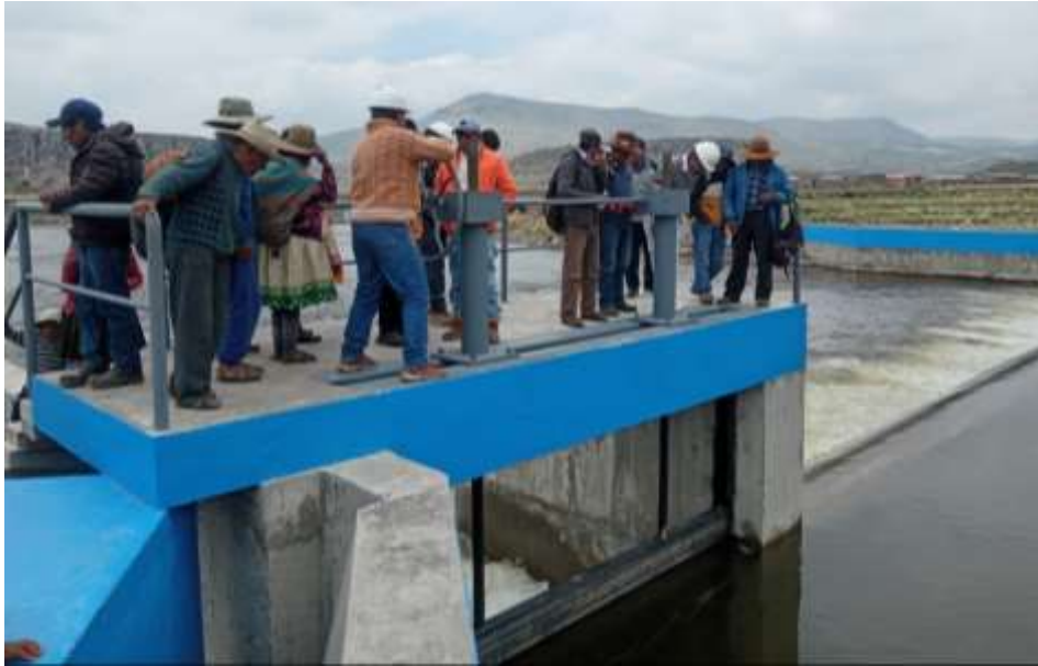
Prueba de apertura de la compuerta del canal de limpia, del barraje móvil.
