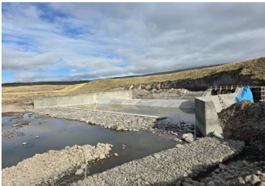
Escollera para evitar socavación del dentellon de la poza de disipación aguas abajo.
