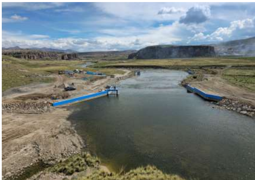
Vista panorámica de la bocatoma de captación barraje mixto puesta en funcionamiento para el sistema de riego tecnificado.
