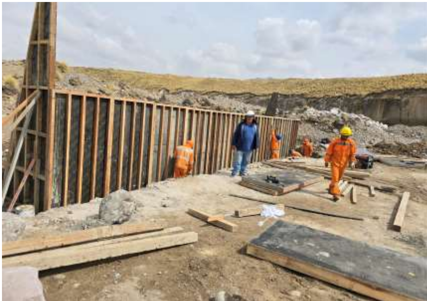
Encofrado de muro de encauzamiento en la margen derecha del río Sañu.
