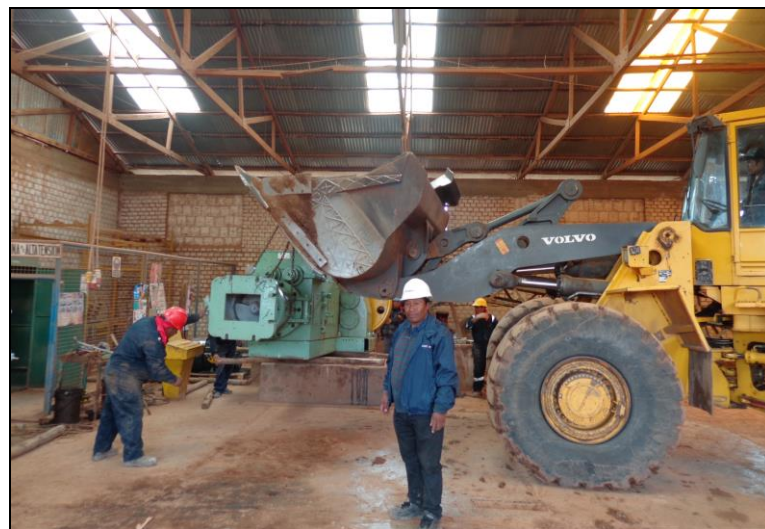
Fotografía 7. Instalación de equipos mecánico para la producción de ladrillos.
