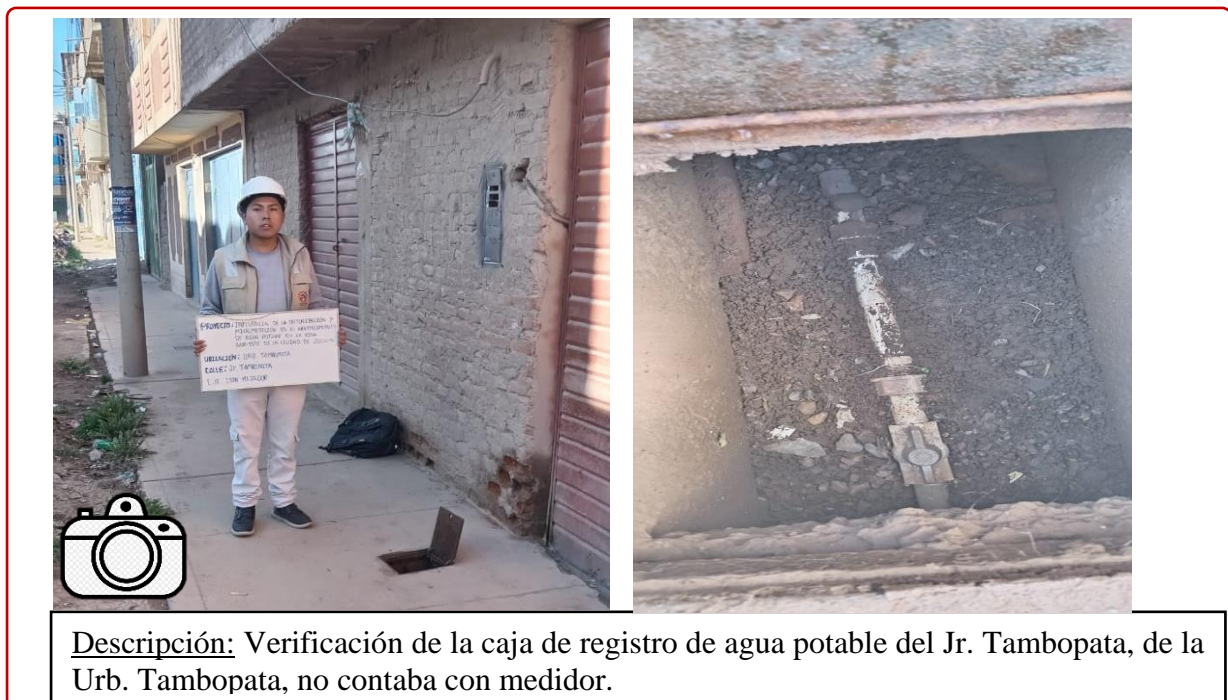
Fotografía 2: Caja de registro de Agua Potable sin medidor Jr. Tambopata Fuente: Propia
