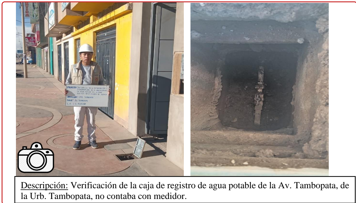
Fotografía 1: Caja de registro de Agua Potable sin medidor Av. Tambopata Fuente: Propia
