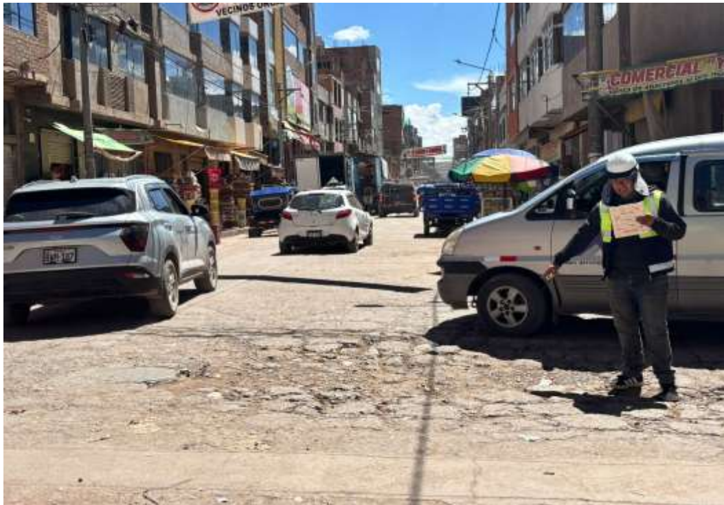
Fotografía 3. Falla de losa dividida del Jr. Sucre
