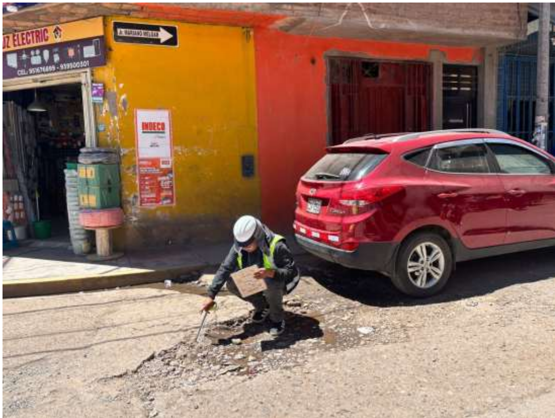
Fotografía 4. Falla de grieta de esquina y losa dividida en el Jr. Mariano Melgar
