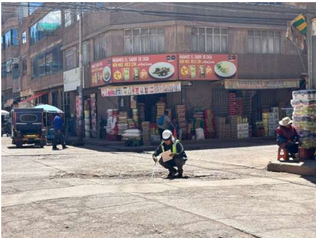
Fotografía 2. Falla escala, descascaramiento y grieta de esquina en el Jr. sucre
