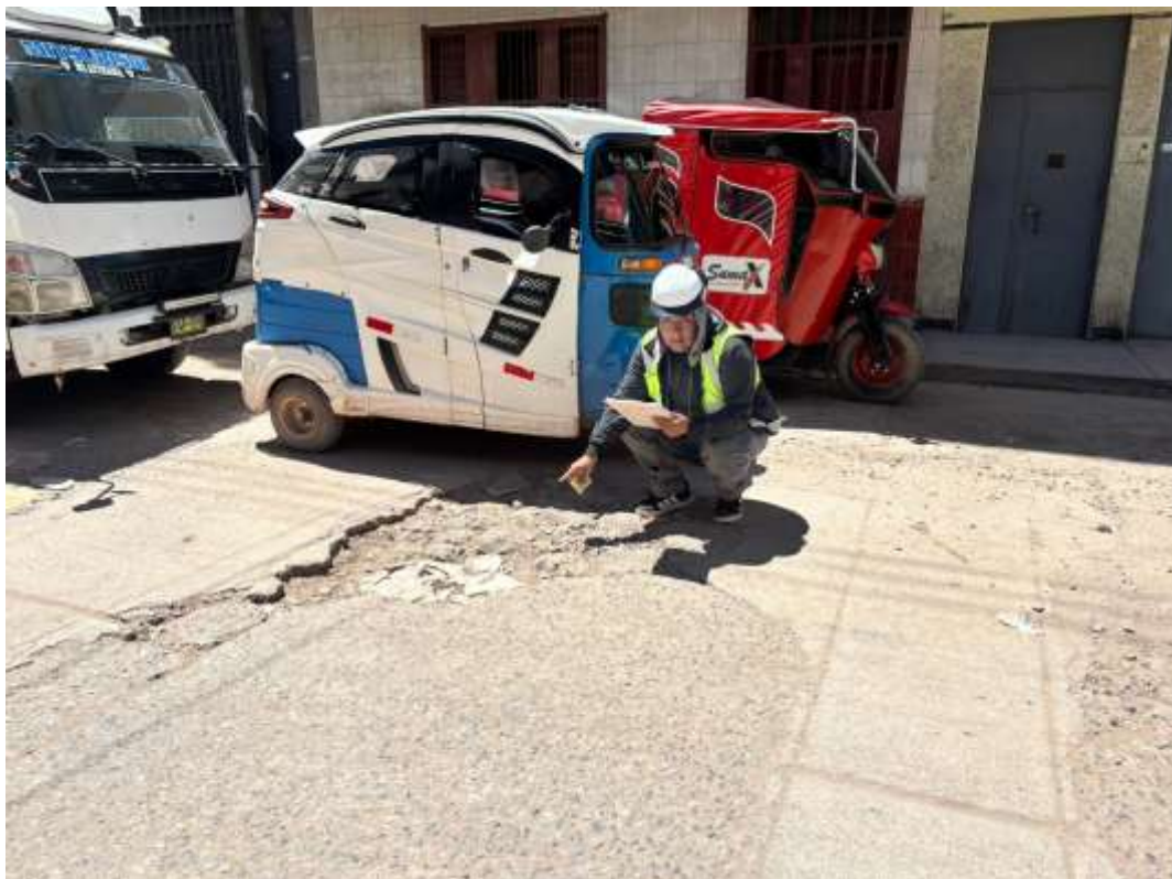
Fotografía 6. Falla de parcheo y escala en el Jr. Mariano Melgar
