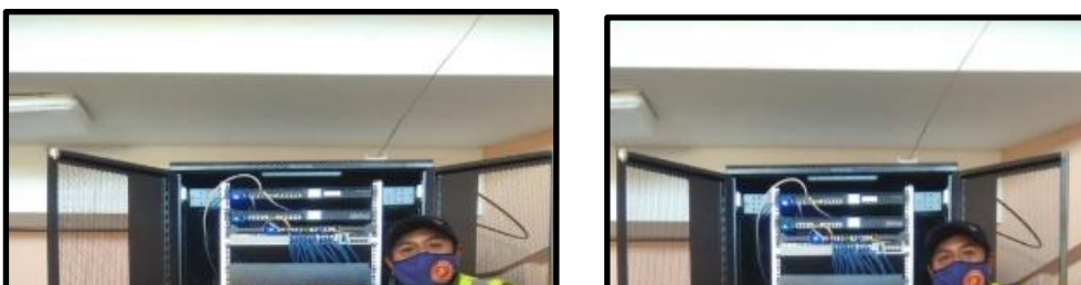
figura 4.16: terminado con servidores-vpn- swicht –cisco-gabinetes
