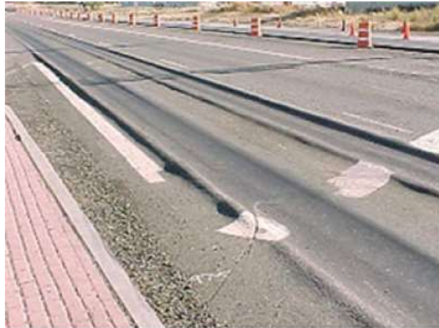
Pavimento con deformaciones plásticas
