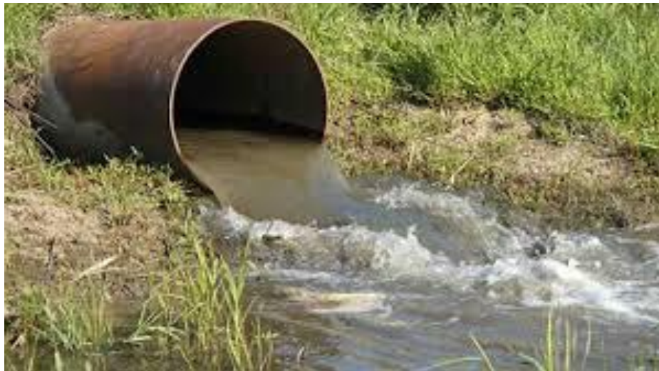
SISTEMA DE EFLUENTE HACIA LA LAGUNA DE OXIDACION
