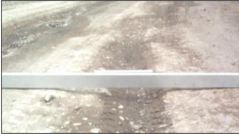
Figura 3. Falla tipo Erosión.
