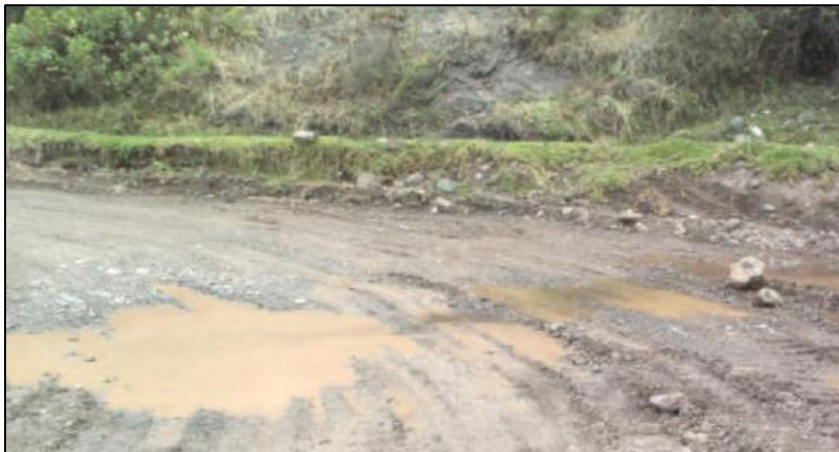
Figura 6. Falla tipo Lodazal.
