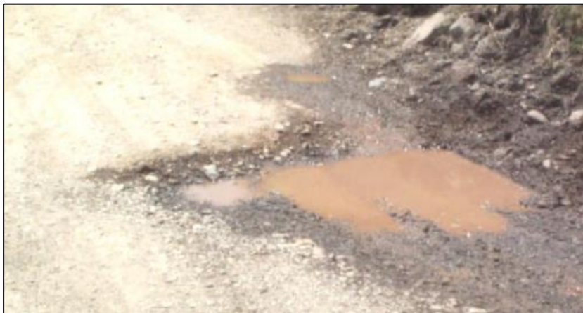
Figura 4. Falla tipo Bache.
