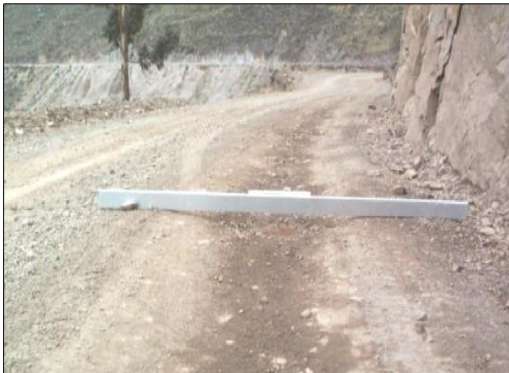
Figura 2. Falla tipo Deformación.
