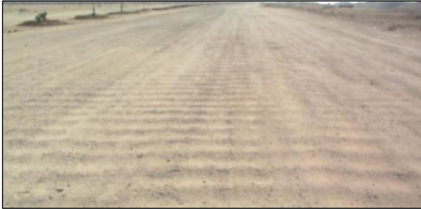
Figura 5. Falla tipo Encalaminado.
