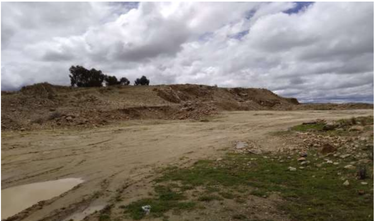
Fotografía 6. Vía afectada por las inclemencias climáticas.
