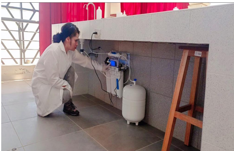
Programación del equipo de osmosis inversa.
