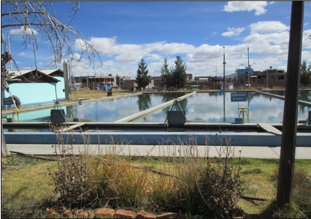
Fotografía 1. Planta de tratamiento
