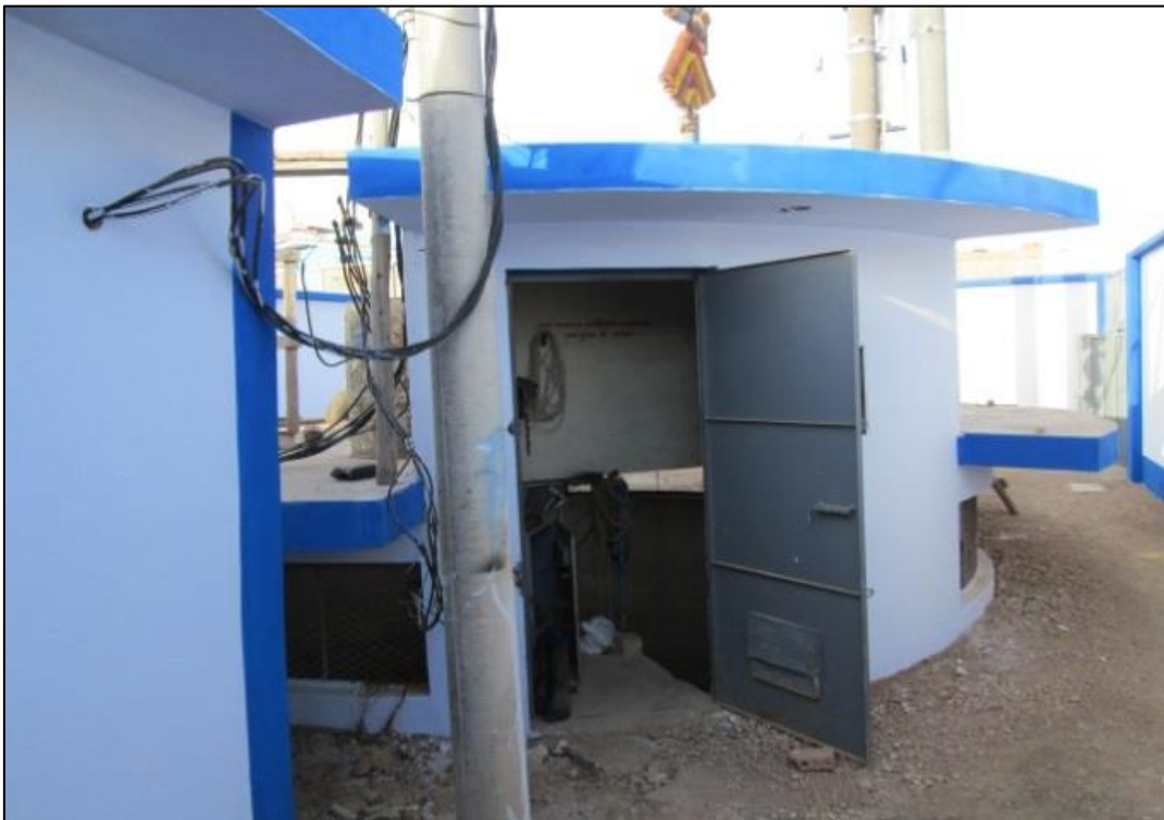
Fotografía 2. Cámaras de bombeo
