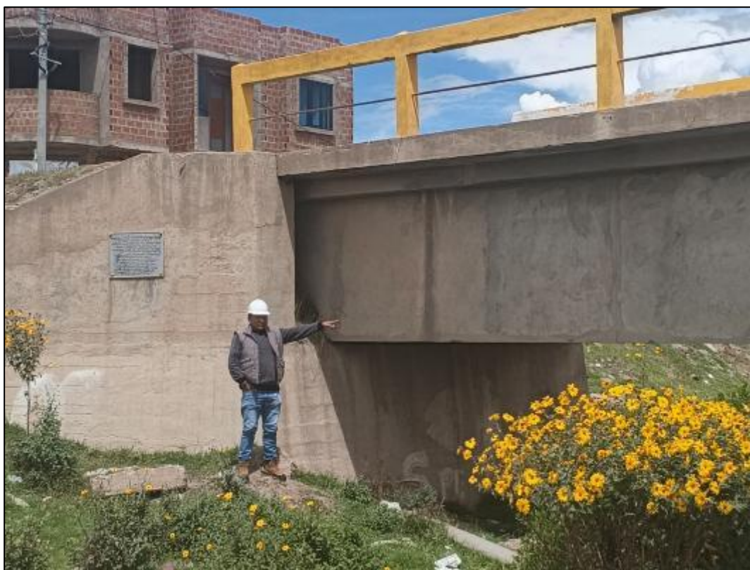
Fotografía 14. Imagen del estado de conservación de la viga del puente.
