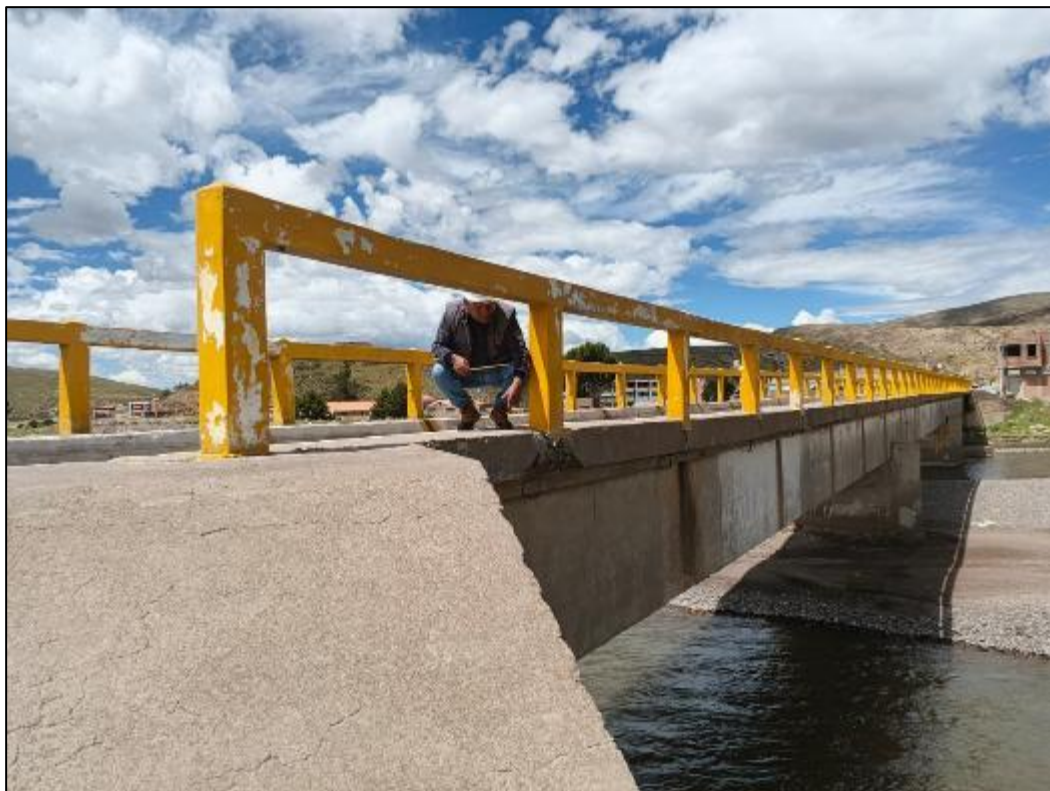
Fotografía 17. Imagen del desprendimiento del concreto en el apoyo de la baranda.
