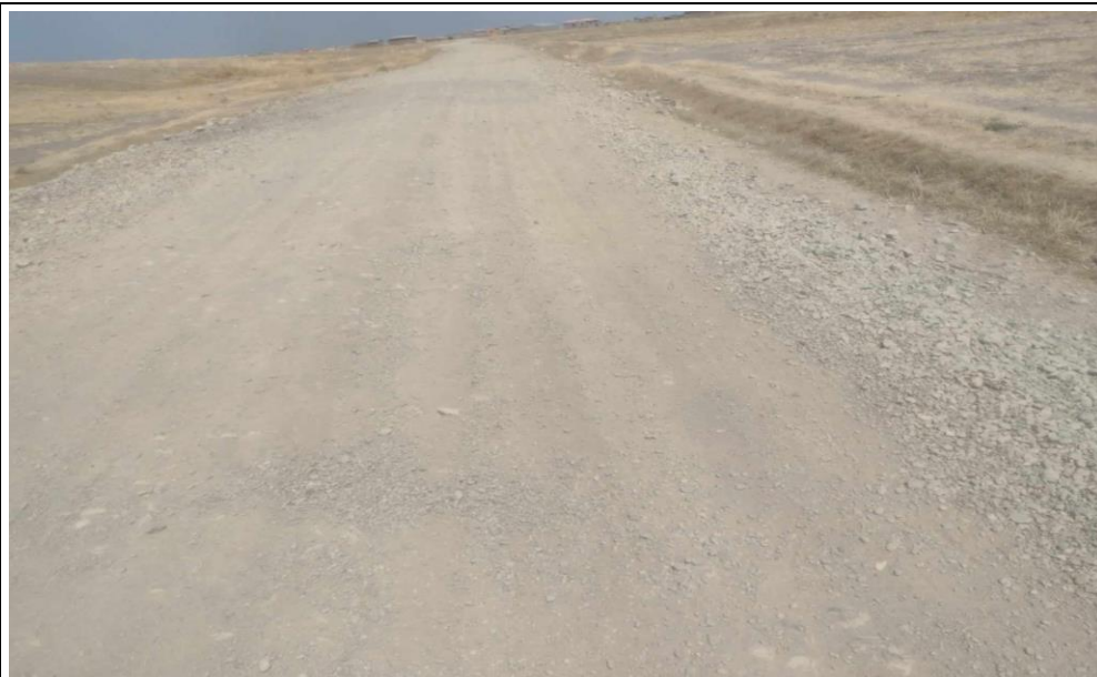
FOTO N° 11: El tramo 3+800 de la carretera necesita una reparación inmediata debido a su notable deterioro.
