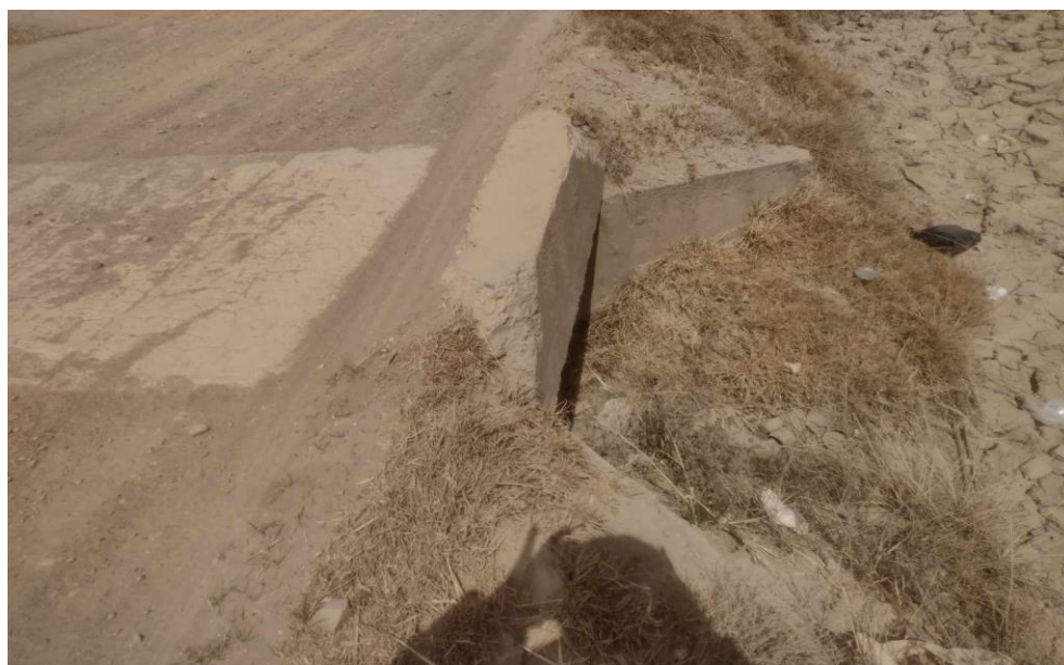
FOTO N° 10: Las instalaciones de drenaje se encuentran en un estado crítico y requieren atención urgente.
