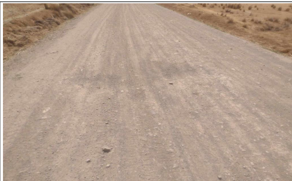
FOTO N° 05: La vía presenta un estado deficiente que requiere una intervención inmediata.
