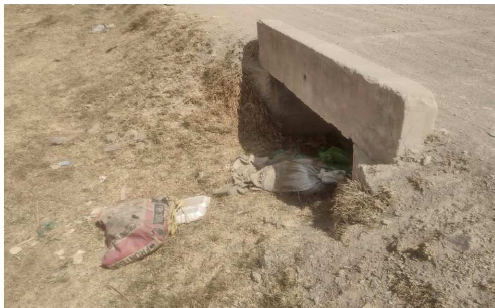
FOTO N° 09: Las obras de drenaje se encuentran en condiciones críticas, con la alcantarilla artesanal de piedra completamente obstruida.
