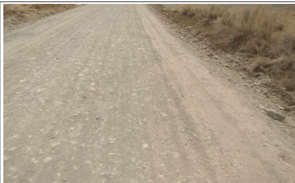
FOTO N° 03: Deficiencia en el mantenimiento de las cunetas, lo que ha generado problemas en su funcionalidad.
