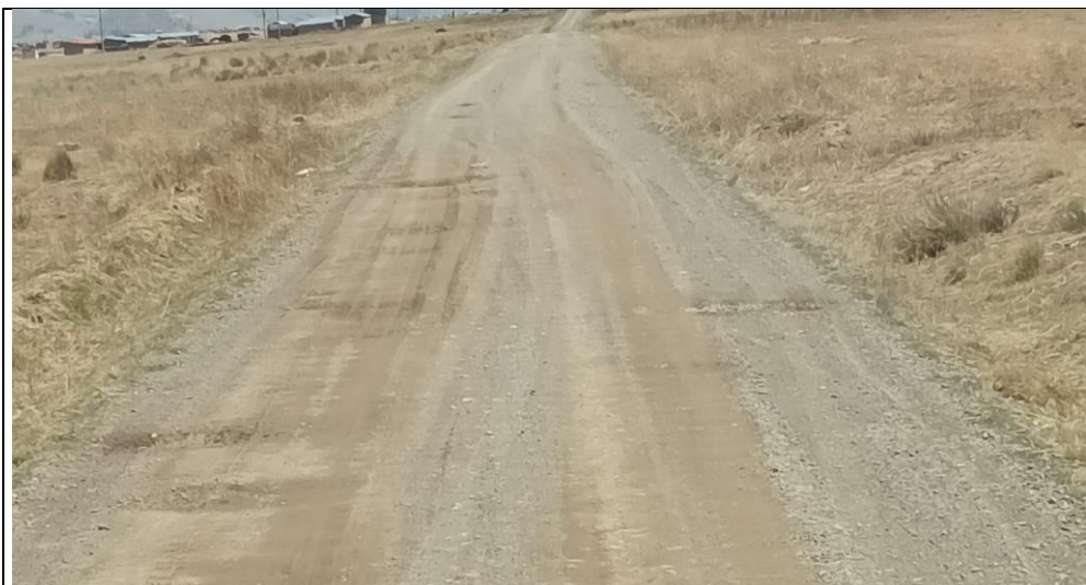
FOTO N° 01: La vía presenta un estado deficiente que requiere una intervención inmediata.
