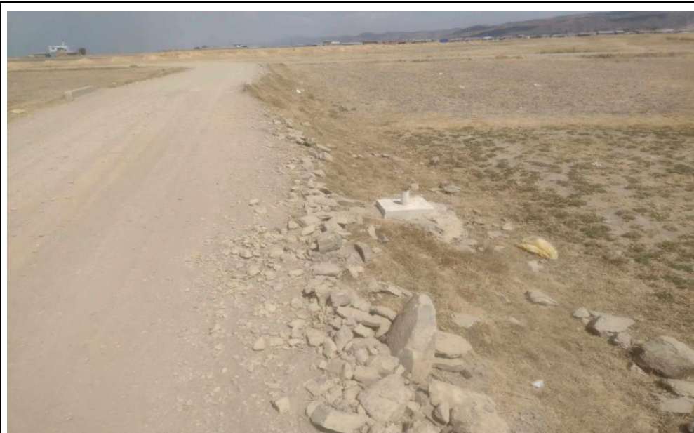
FOTO N° 15: Señalizaciones se encuentran en mal estado en el KM 4+100
