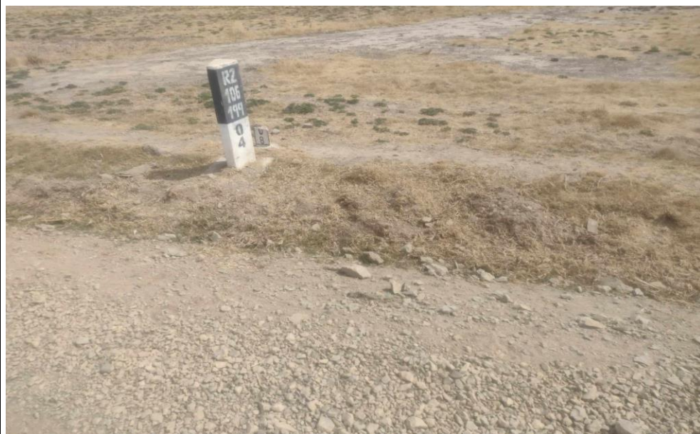
FOTO N° 13: Las cunetas se encuentran en un estado moderado o regular y necesitan limpieza y reconstrucción inmediata en la progresiva KM 4+000.
