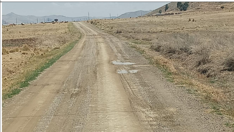
FOTO N° 02: Deficiencia en el mantenimiento de las cunetas, lo que ha generado problemas en su funcionalidad.
