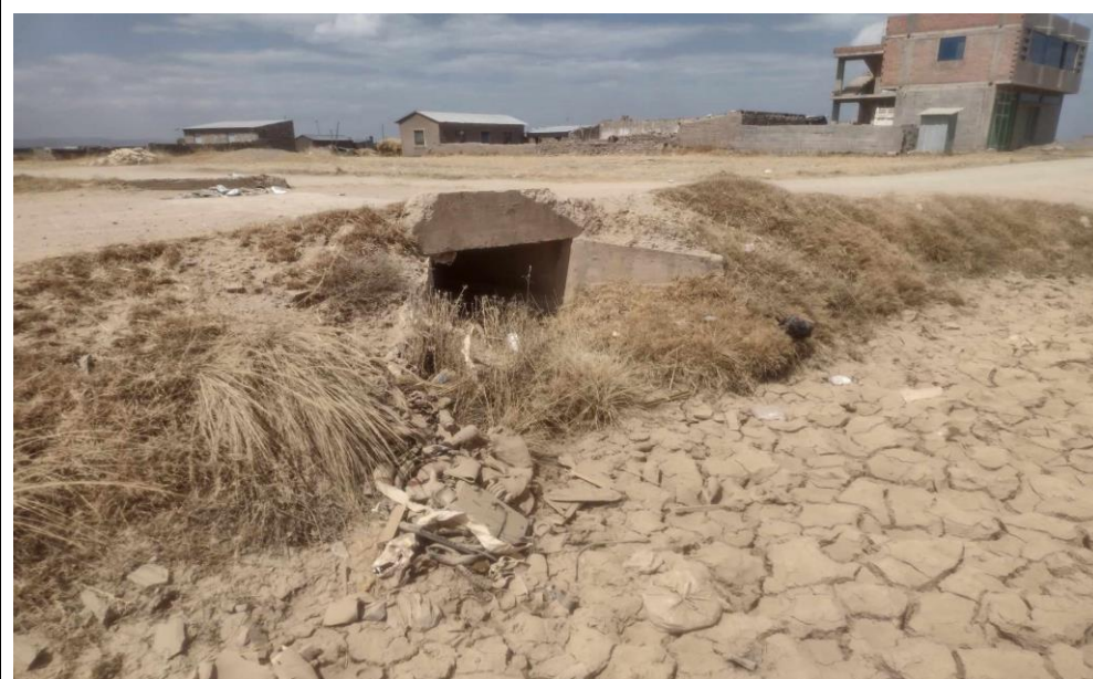
FOTO N° 16: Las estructuras de drenaje están en estado crítico, ya que la alcantarilla artesanal de piedra está totalmente bloqueada. Progresiva KM 2+100
