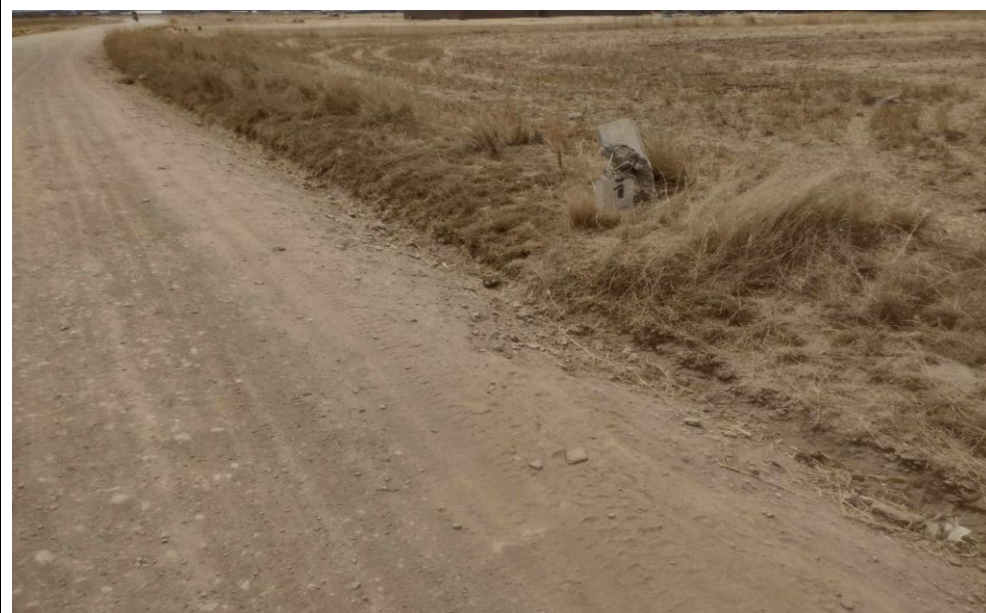
FOTO N° 04: Falta de mantenimiento en las cunetas y en el hito de concreto, que presenta un desgaste evidente de la pintura y daños parciales en su estructura.
