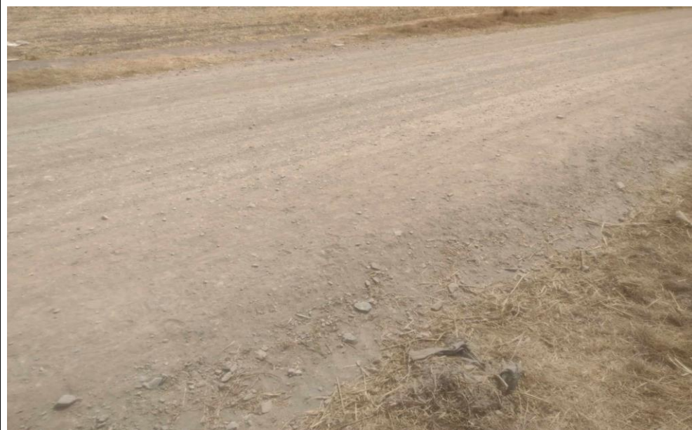
FOTO N° 06: Ausencia de mantenimiento en la calzada del camino vecinal
