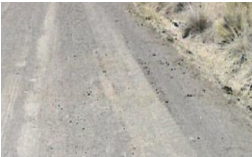
FOTO N° 12: Se puede notar que la vía requiere una reparación con urgencia.
