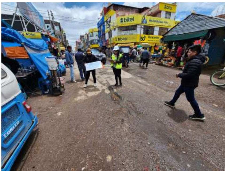
Fotografía 12. Inspección visual de fallas de tipo ahuellamiento sobre la vía.
