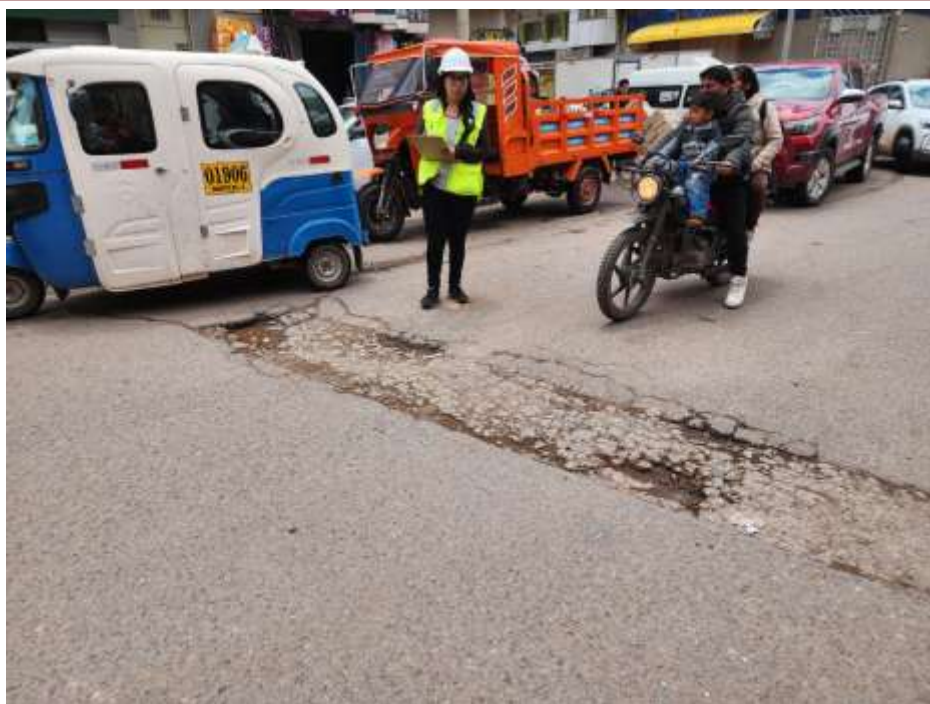
Fotografía 3. Verificación de fallas de tipo parcheo en severidad media.
