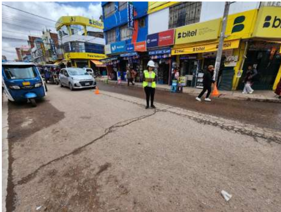
Fotografía 8. Verificación de fallas de tipo fisuras longs. y transv., y piel de cocodrilo.
