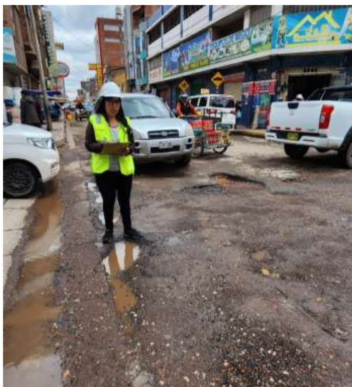
Fotografía 10. Verificación de fallas de tipo hueco en severidad alta.
