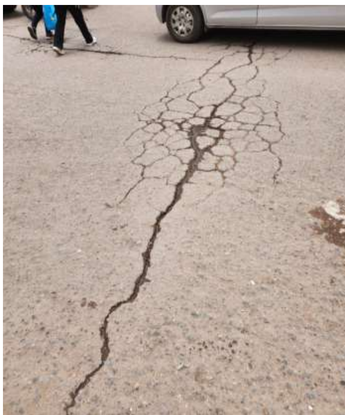
Fotografía 2. Verificación de fallas de tipo piel de cocodrilo en severidad media.
