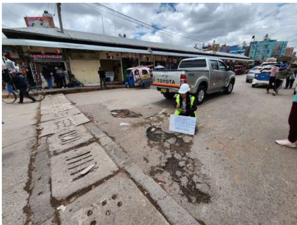
Fotografía 1. Inspección superficial de fallas de tipo piel de cocodrilo en severidad alta.
