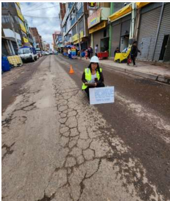
Fotografía 9. Verificación de fallas de tipo piel de cocodrilo en severidad media.
