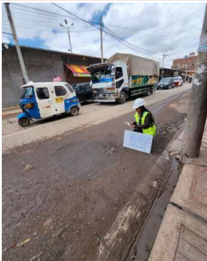
Fotografía 5. Verificación de fallas de tipo fisuras longitudinales y transversales
