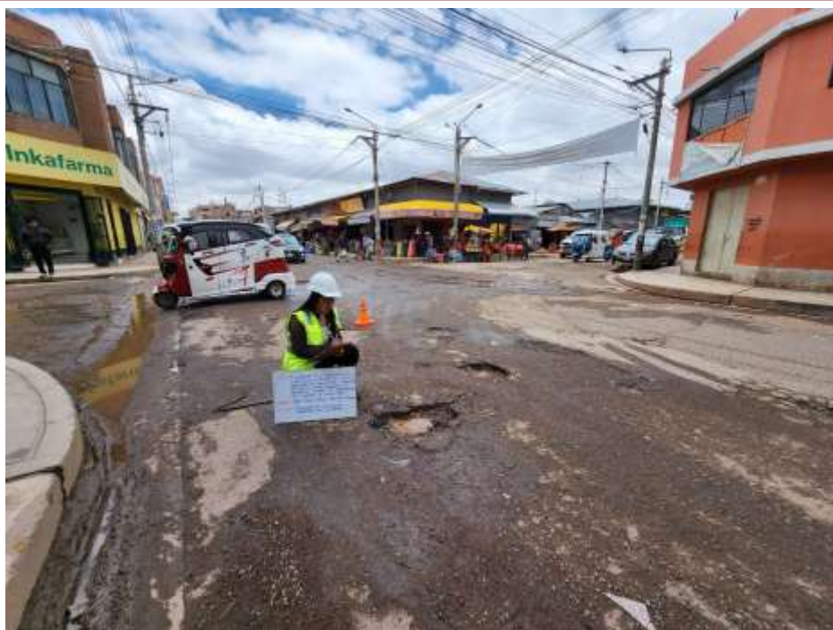
Fotografía 7. Verificación de fallas de tipo hueco con severidad media.
