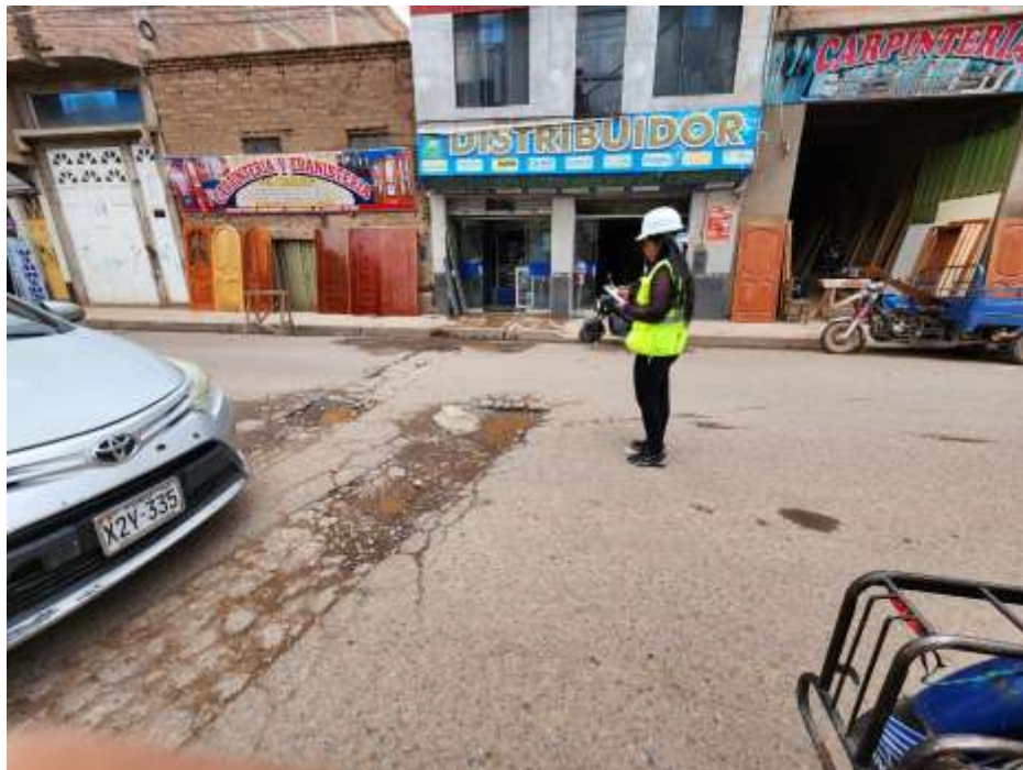
Fotografía 4. Verificación de fallas de tipo parcheos en severidad media.
