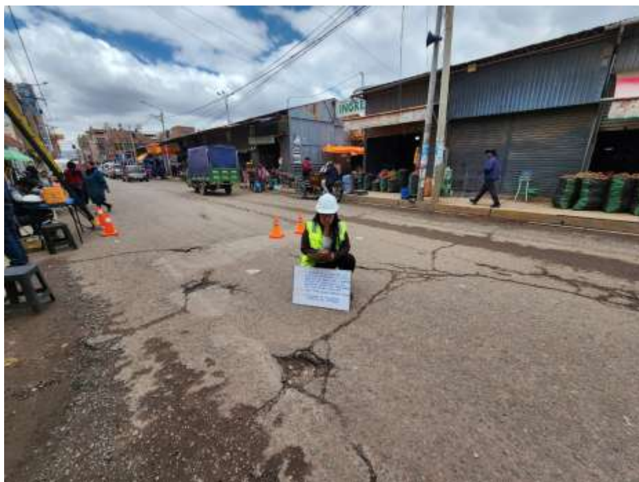
Fotografía 6. Verificación de fallas de tipo agrietamiento en bloque.
