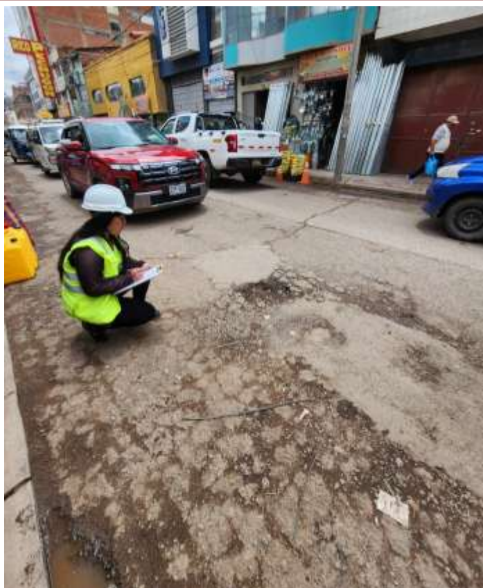
Fotografía 11. Verificación de fallas de tipo piel de cocodrilo y parcheo.
