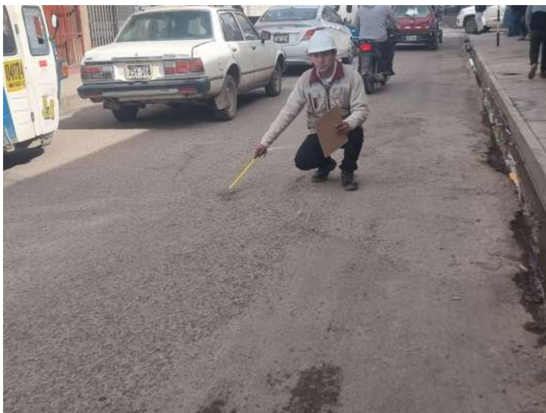
Fotografía N° 8. Falla ubicada en el segmento 8.
