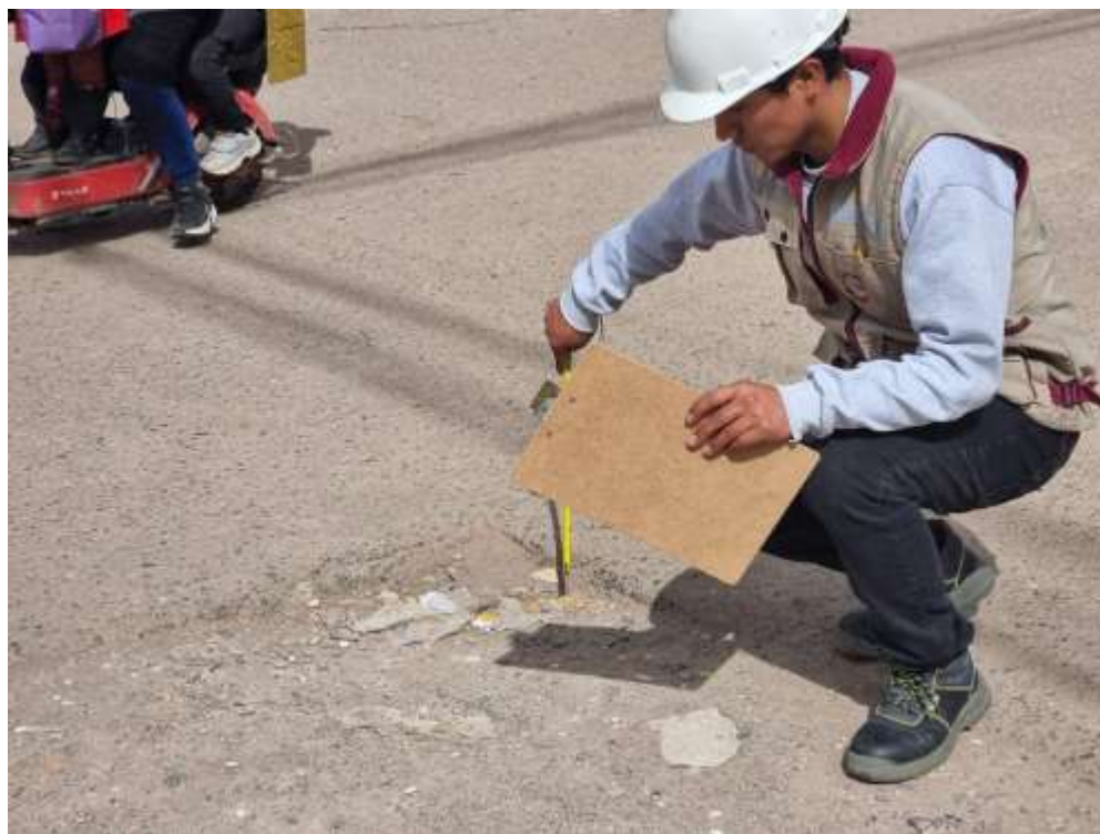
Fotografía N° 10. Falla ubicada en el segmento 10.
