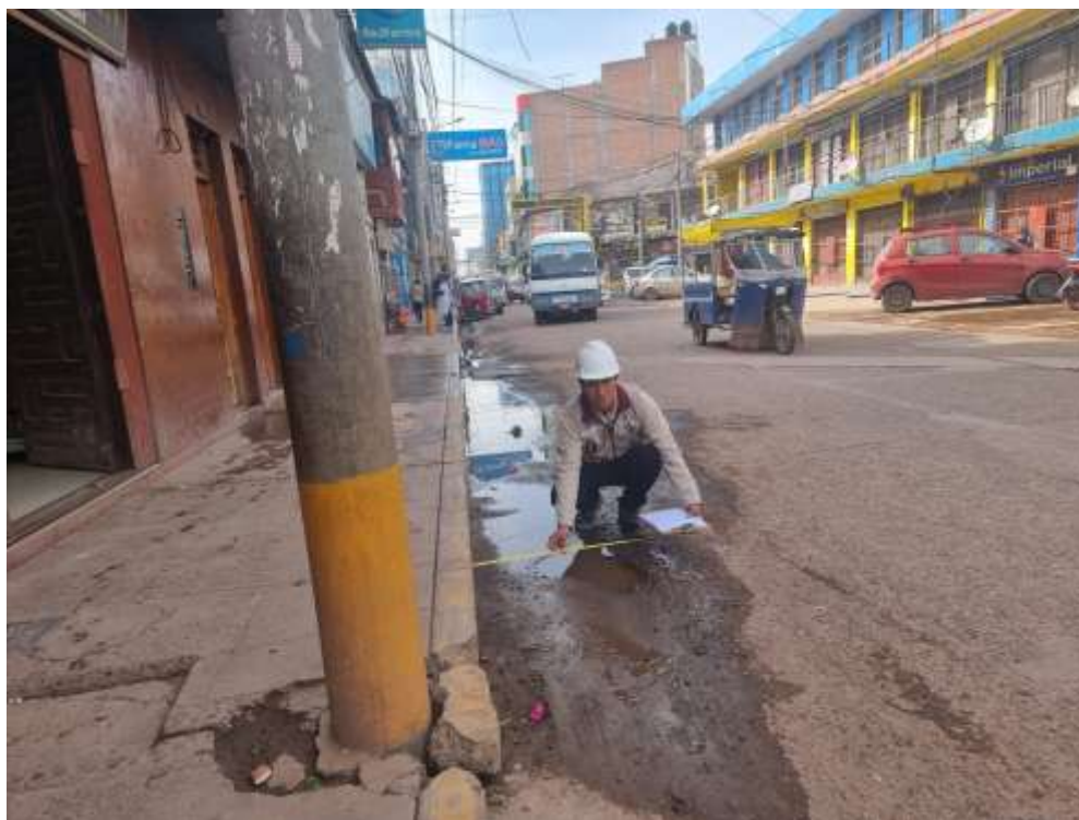
Fotografía N° 2. Falla ubicada en el segmento 2.
