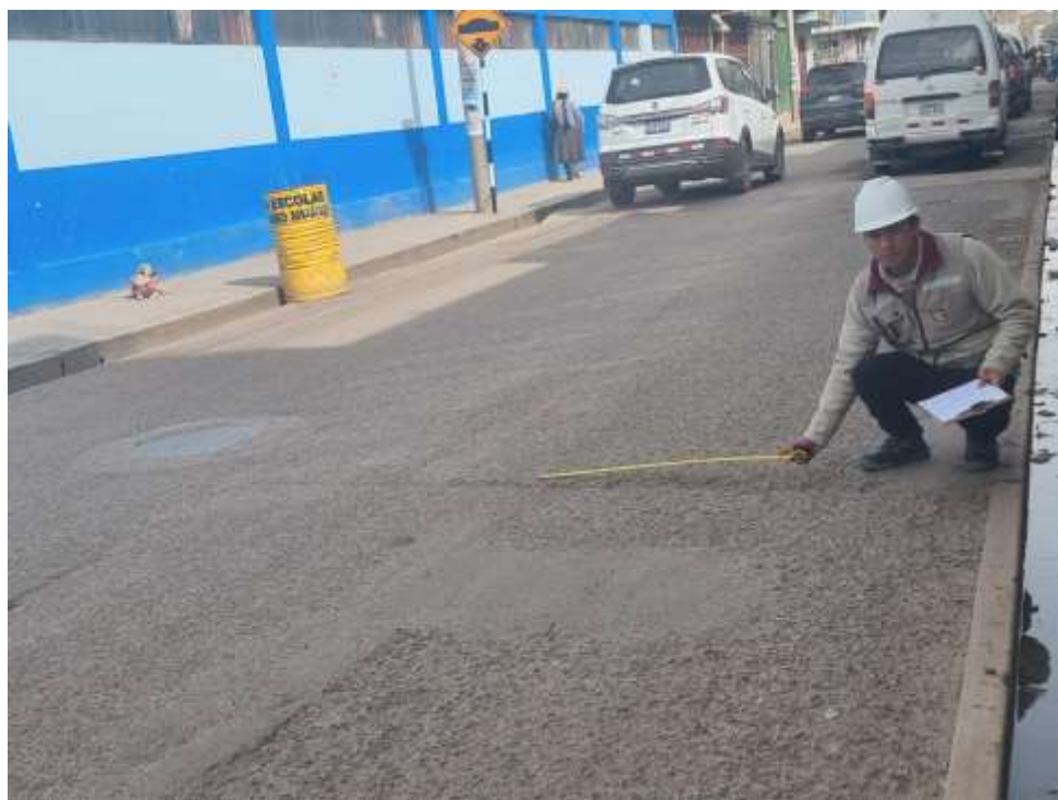
Fotografía N° 9. Falla ubicada en el segmento 9.
