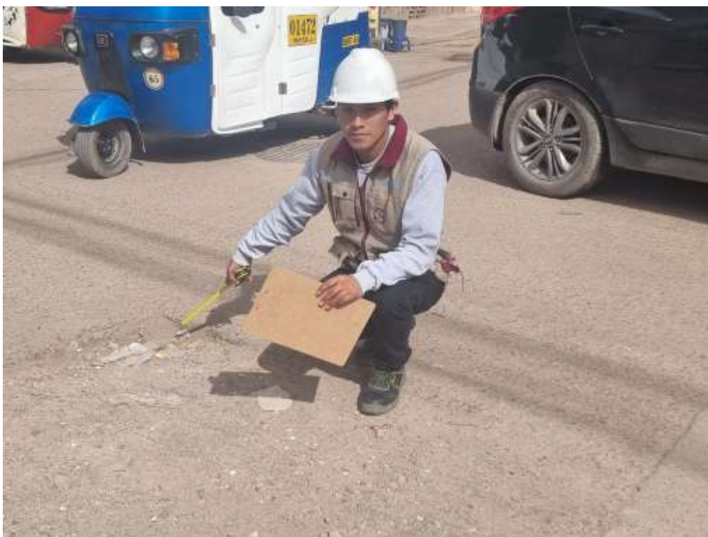
Fotografía N° 5. Falla ubicada en el segmento 5.
