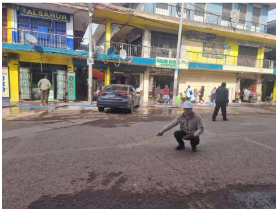
Fotografía N° 3. Falla ubicada en el segmento 3.
