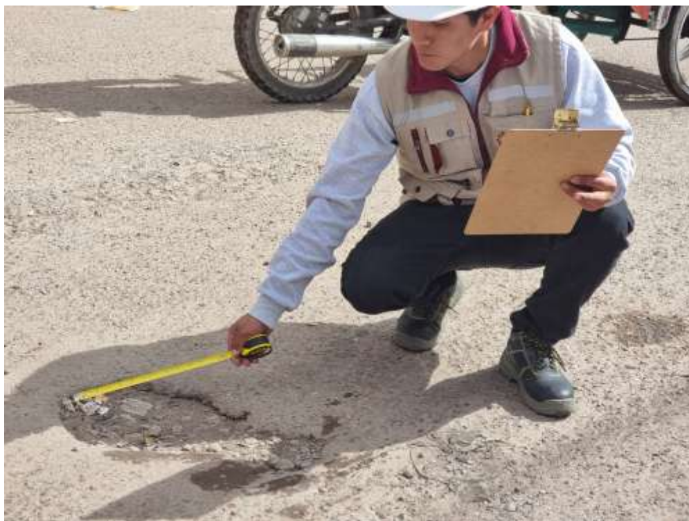
Fotografía N° 4. Falla ubicada en el segmento 4.
