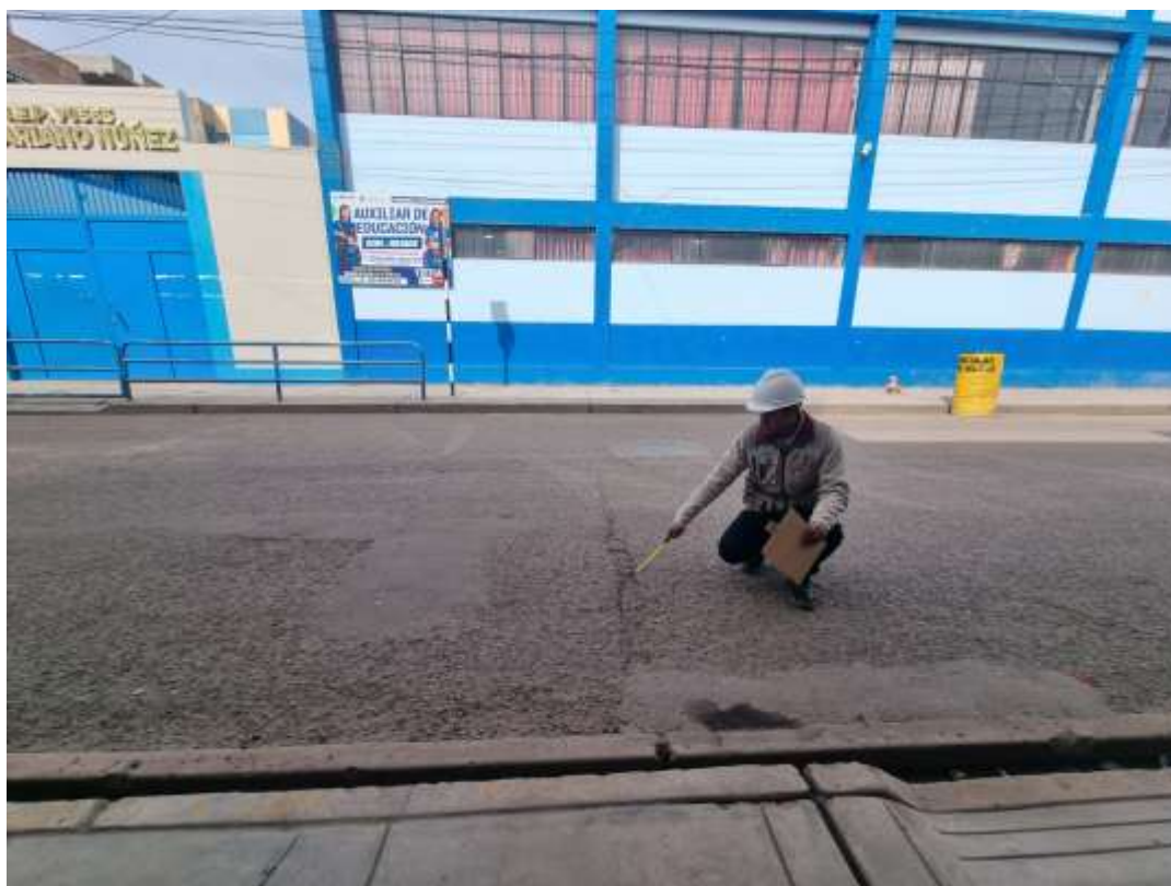
Fotografía N° 7. Falla ubicada en el segmento 7.
