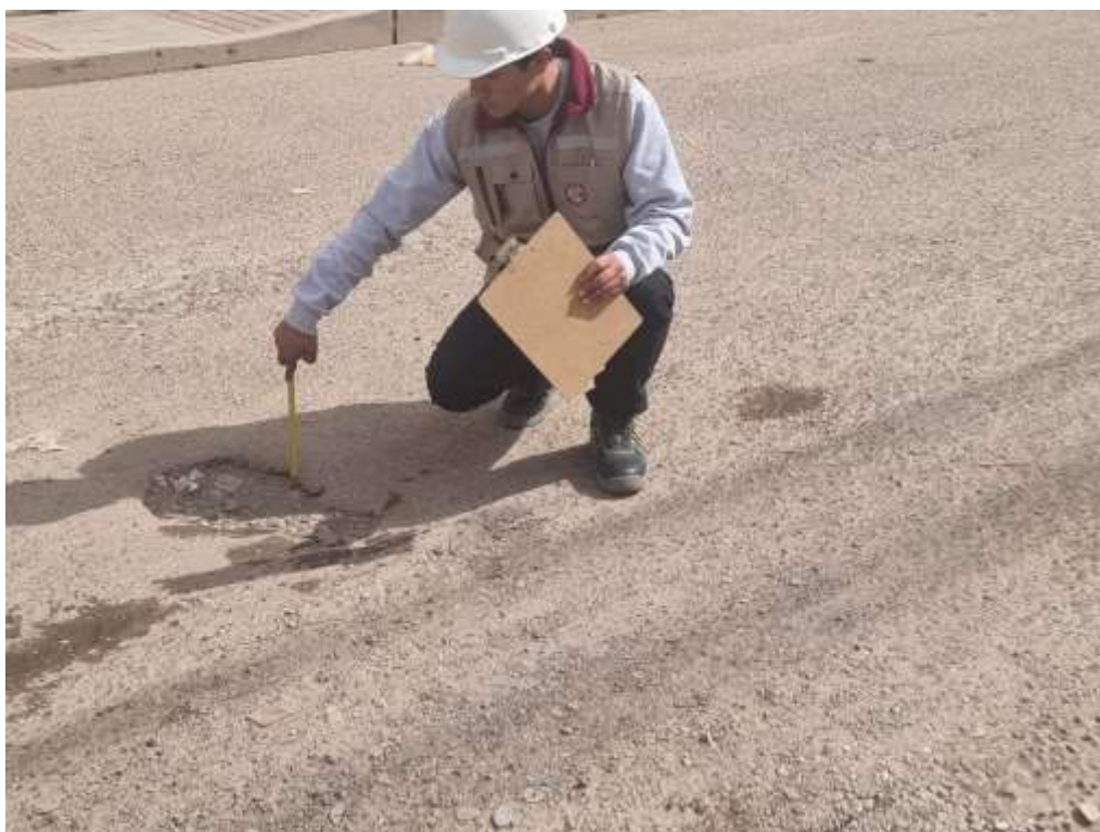
Fotografía N° 6. Falla ubicada en el segmento 6.
