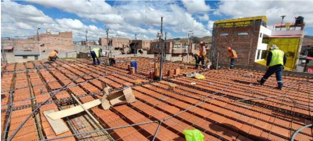
Fotografía 8: Visita a obra para recolección de información partida tendido de tuberías para instalaciones eléctricas en losa aligerada proyecto vivienda familiar
