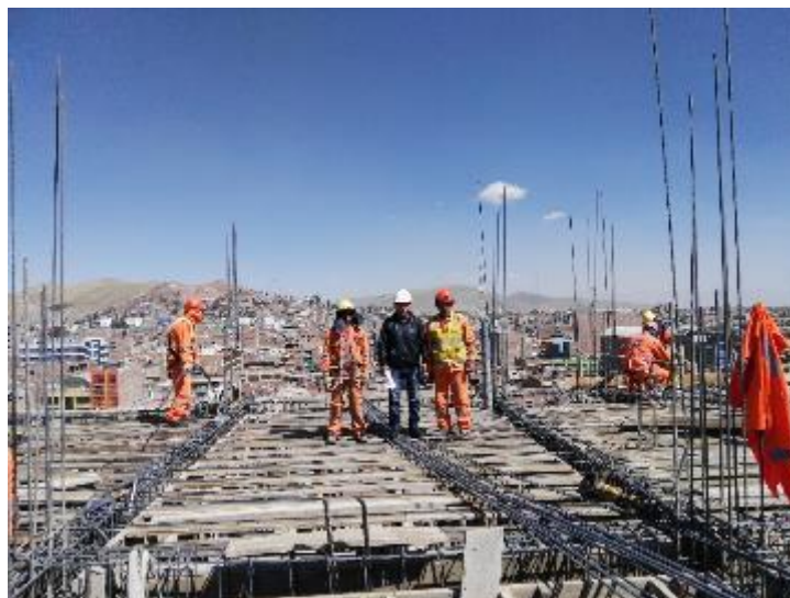
Fotografía 4: Visita a obra para recolección de información. entablado en losa aligerada proyecto hotel y departamentos
