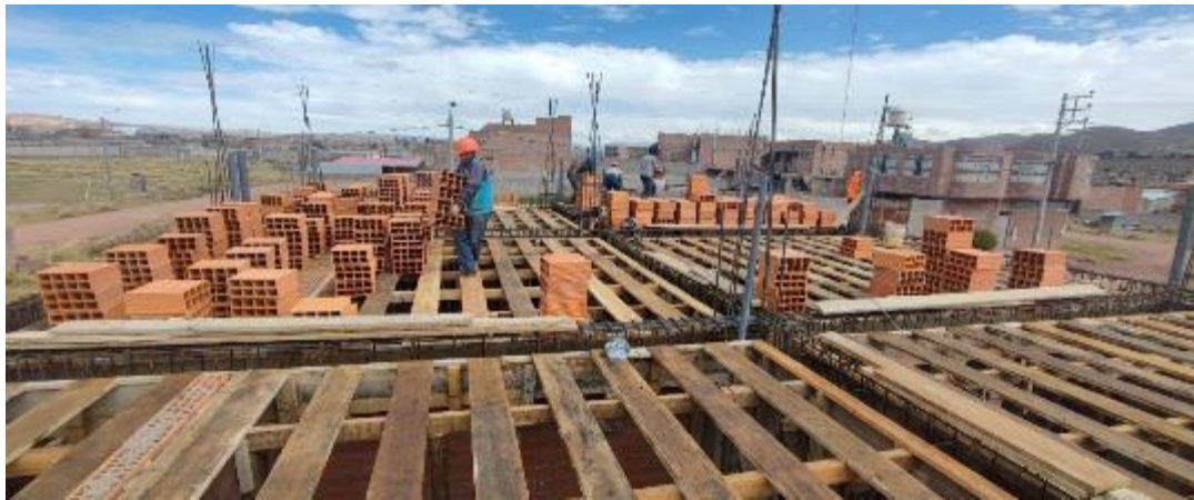
Fotografía 6: Visita a obra para recolección de información. habilitado de ladrillo de 30x30x15 cm en losa aligerada. proyecto vivienda familiar.
