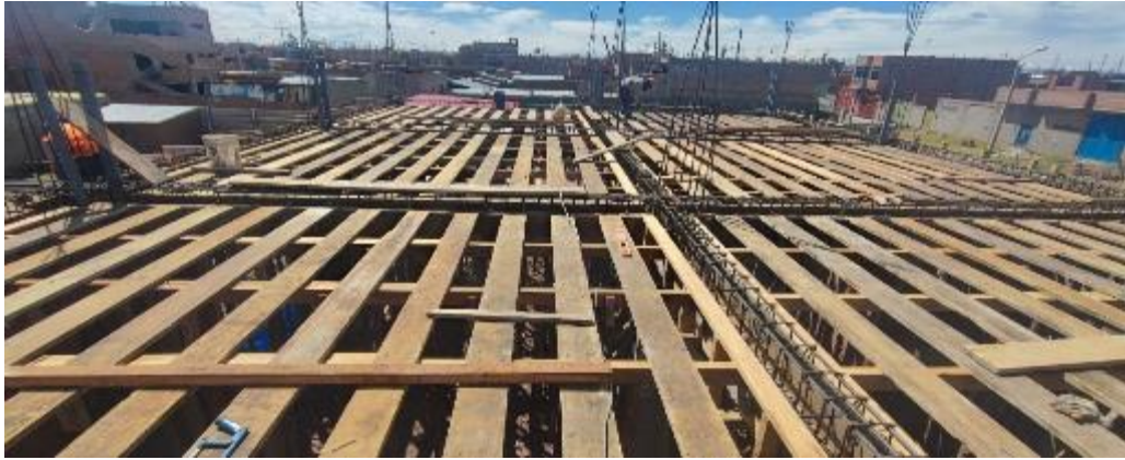
Fotografía 5: Visita a obra para recolección de información. Entablado en losa aligerada proyecto vivienda familiar.
