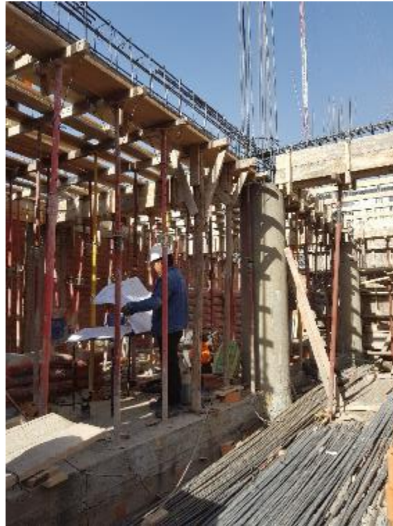
Fotografía 3: Visita a obra para recolección de información. Partida solereado y apuntalado en losa aligerada.
