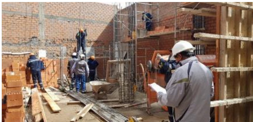
Fotografía 12: Visita a obra para recolección de información encuesta sobre el sistema de viguetas pretensadas. proyecto depósito y departamentos
