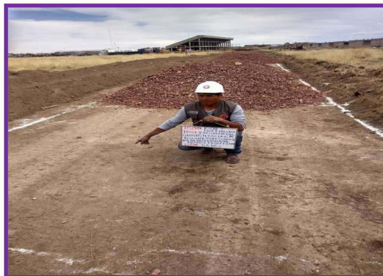
Fotografía N° 02: Conformación de la subestructura sin geotextil de control con Material de relleno de la cantera Taparachi
