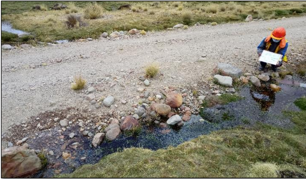
Fotografía 13. La fotografía muestra un deterioro de ahuellamiento mayor a 10 cm
