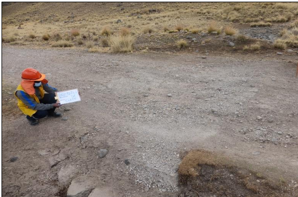
Fotografía 14. La fotografía muestra un deterioro de ahuellamiento mayor a 5 cm
