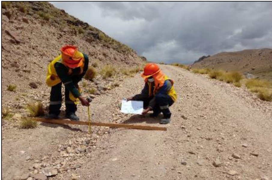
Fotografía 13. La fotografía muestra un deterioro de ahuellamiento mayor a 10 cm
