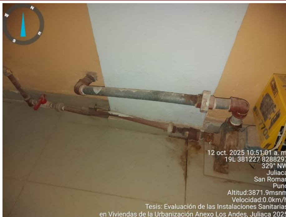
Fotografía 09: Verificación de las tuberías internas de agua con evidencia de oxidación y uniones no estancas.
