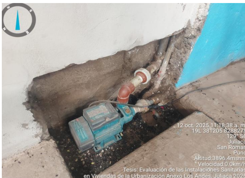
Fotografía 01: Verificación de la bomba de agua con conexiones expuestas y sin recubrimiento impermeable.
