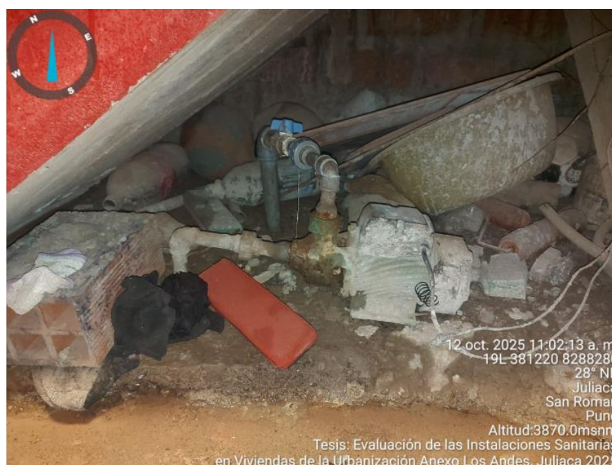
Fotografía 04: Verificación de la conexión de bomba doméstica ubicada bajo escaleras sin protección sanitaria.
