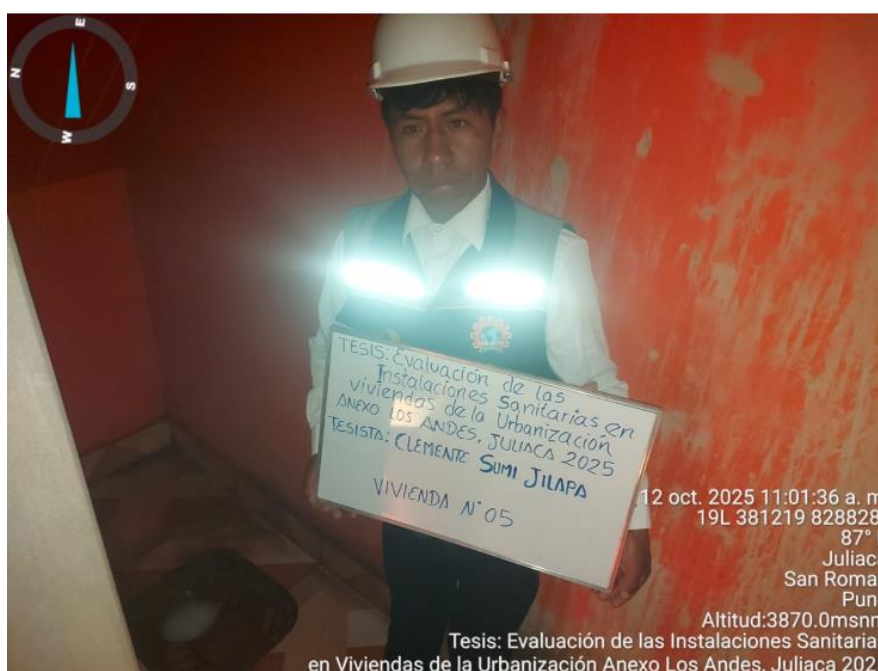
Fotografía 06: Estado del inodoro y piso con signos de humedad y deterioro superficial.
