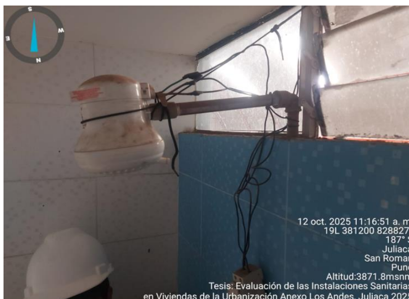
Fotografía 02: Verificación de la ducha eléctrica con instalación inadecuada y cableado expuesto.
