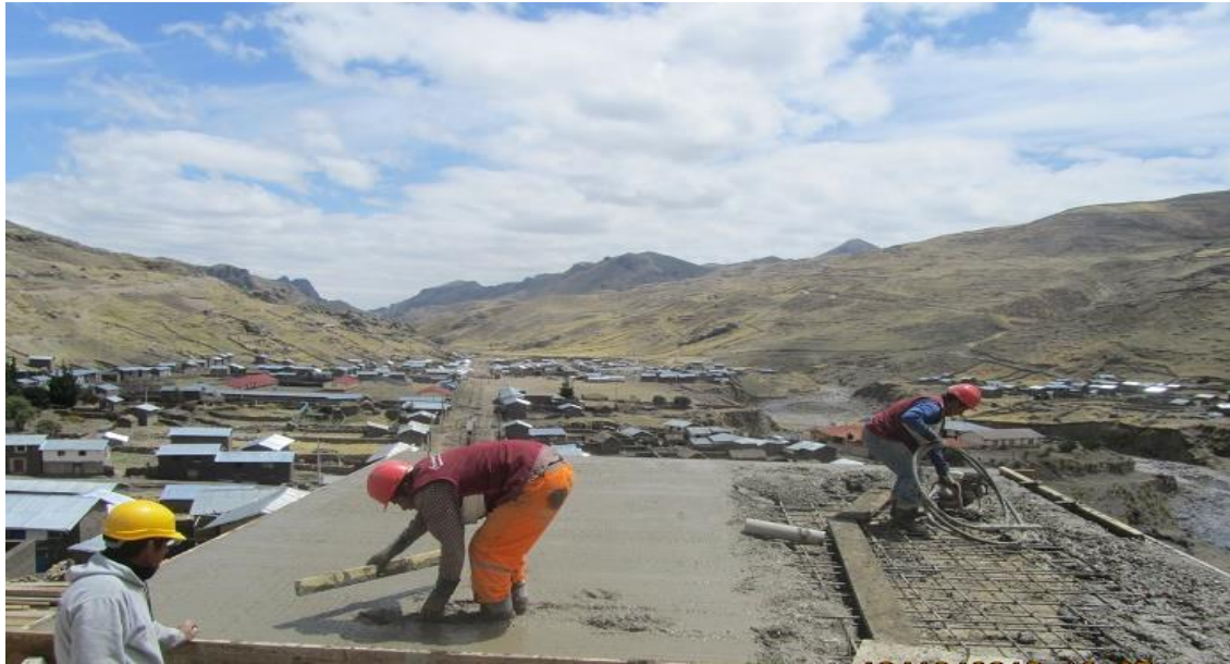
Vista Fotográfica de llenado de losa de concreto según detalles de modelos realizados
