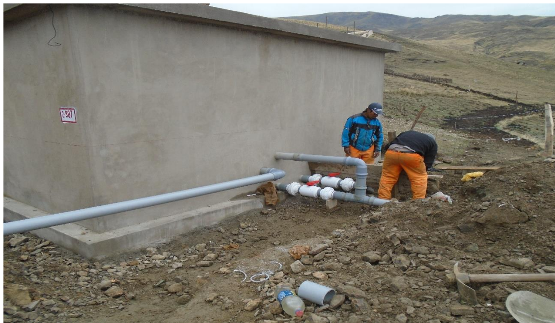
Vista fotográfica de instalaciones hidráulicas en reservorio
