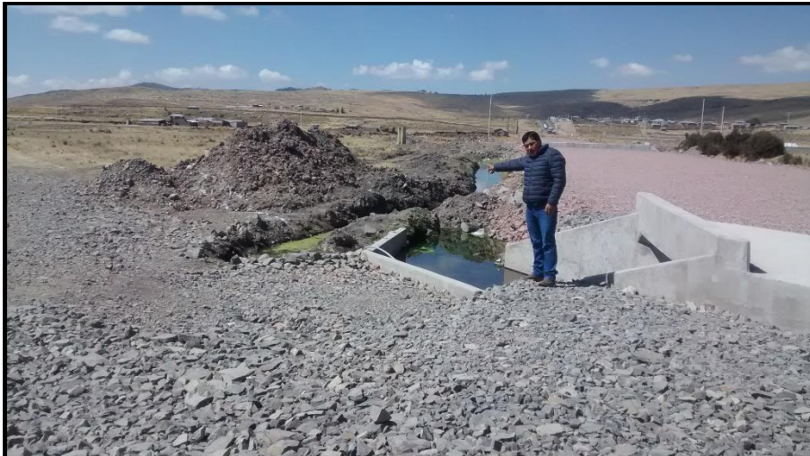
Fotografía 19. Material excedente ubicado en lugares inadecuados.
