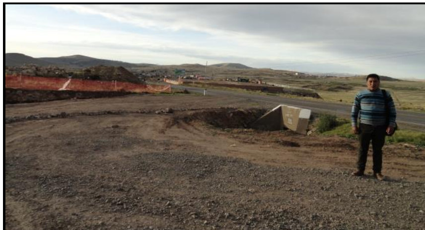
Fotografía 16. Materiales excedentes procedentes de la construcción de la vía.
